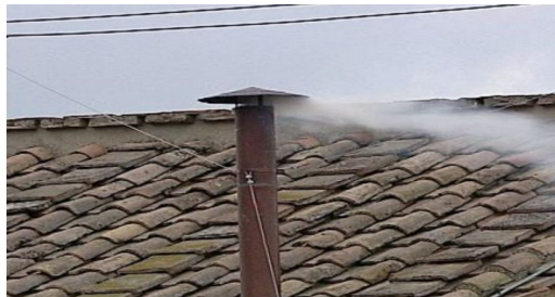
-Figura 30. Conducto con sombrerete.
