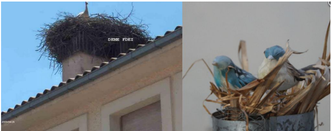
-Figura 29 Conductos obstruidos por nidos de pájaros.
