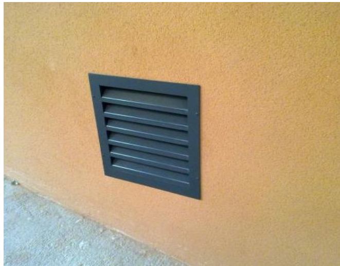
-Figura 35. . Rejilla de ventilación.
