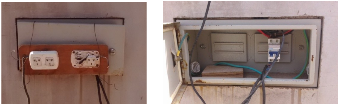
Figura 10: pilar de acometida - tablero de
