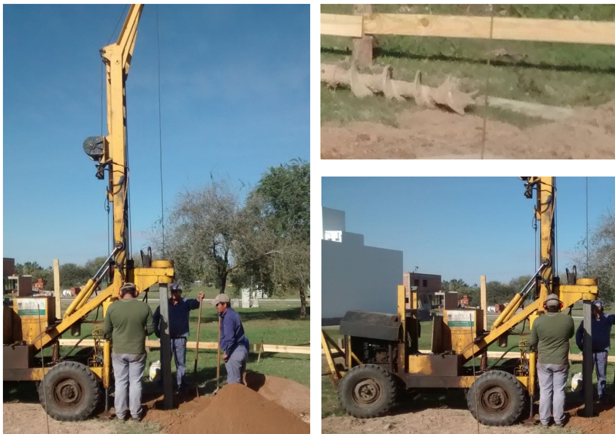
Figura 18: en la imagen superior de la derecha se observa el cerco de madera. En las restantes imágenes se aprecian a los trabajadores operando la máquina pilotera.
