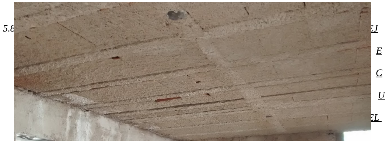
Figura 61: castigado cementicio en la cara inferior de la losa de entrepiso.
