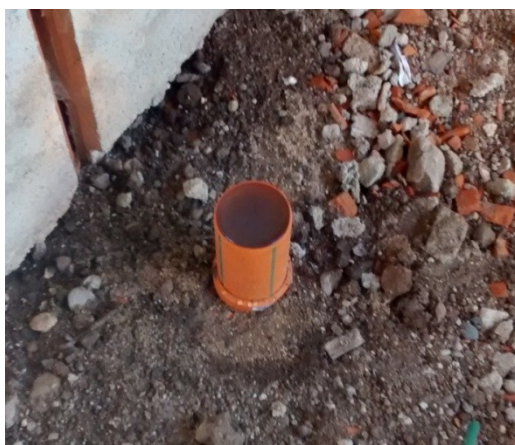
Figura 46: prueba hidráulica realizada en forma deficiente
