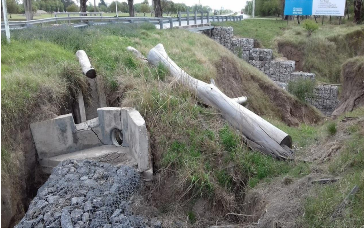
Fotografía 2. Destrucción de infraestructura en cercanías de Monte Ralo
