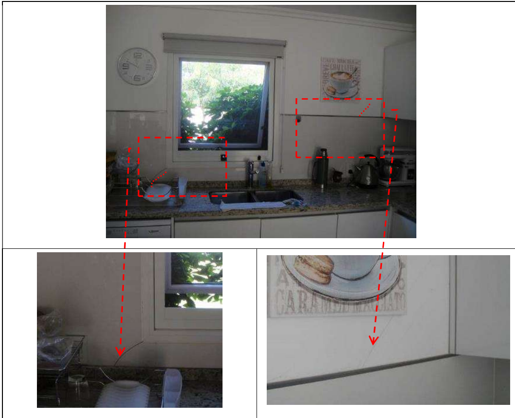
Ilustración 7 – Agrietamiento de muro de fachada (vista interior) - Cocina
