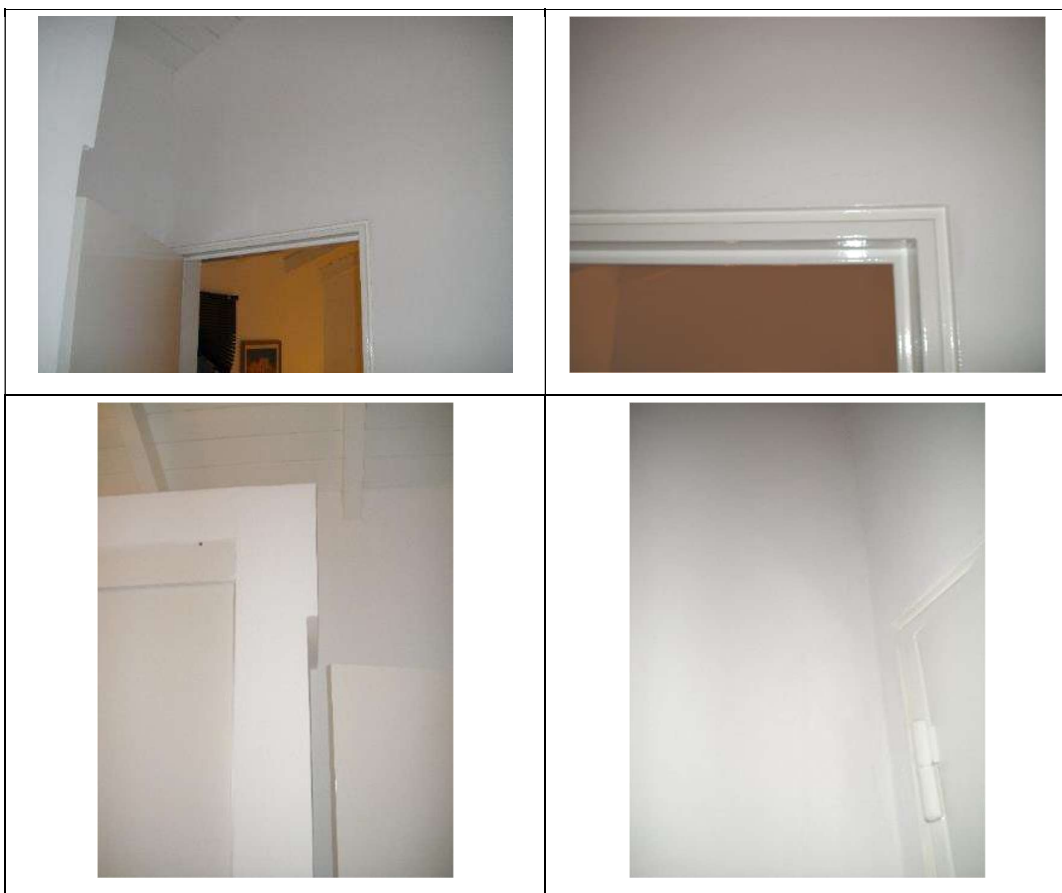
Ilustración 31 - Daños en dormitorio principal
