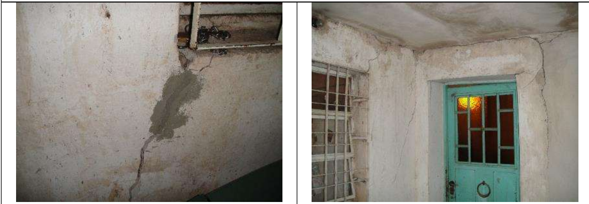
Hall de ingreso - agrietamiento
