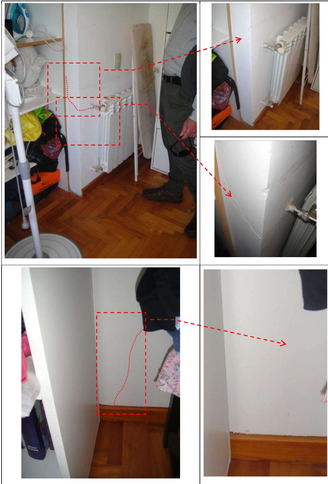
Ilustración 10 - Fisuras en muro divisorio entre dormitorios - Vista dormitorio 2
