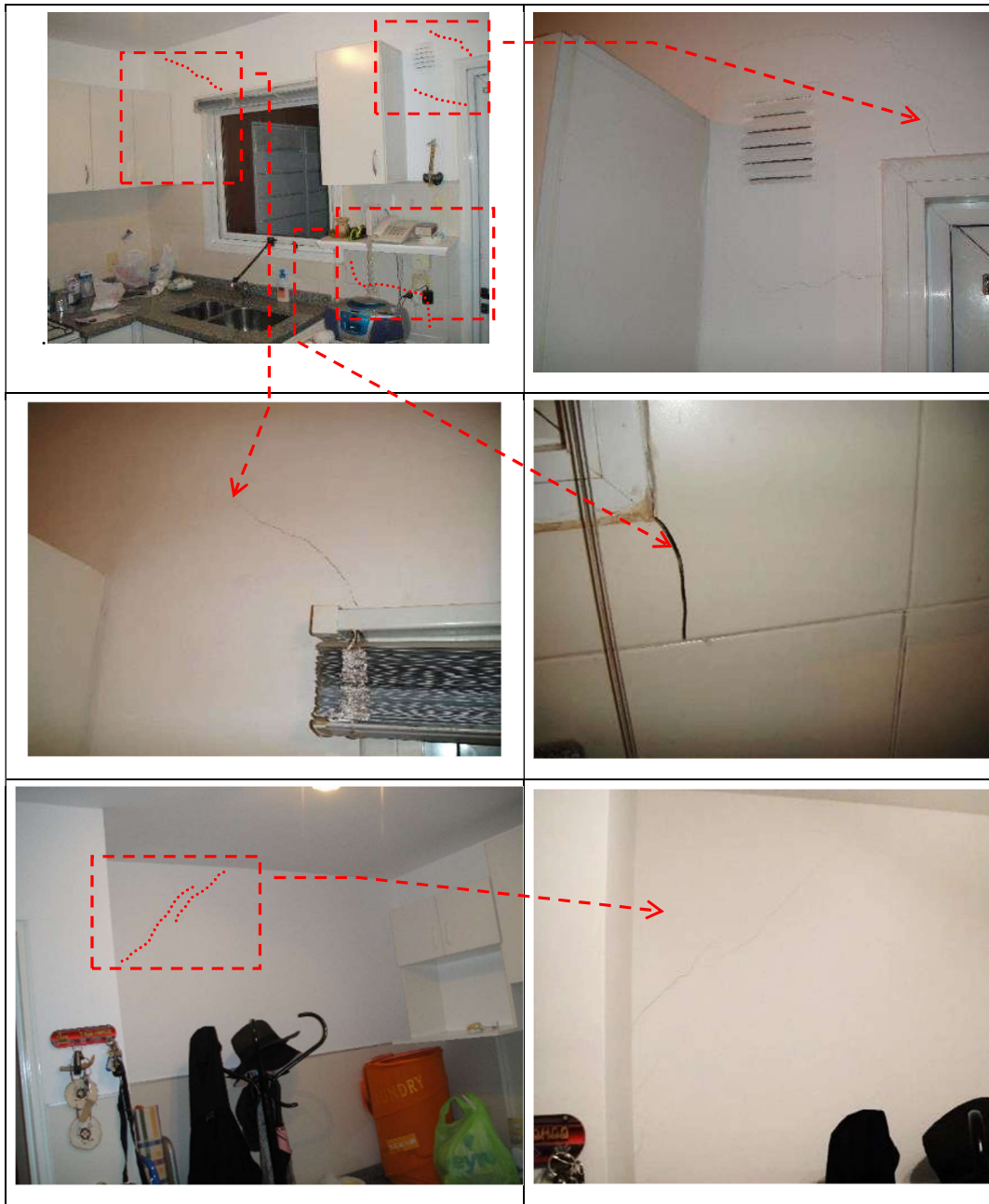
Ilustración 27 - Detalle de daños en cocina
