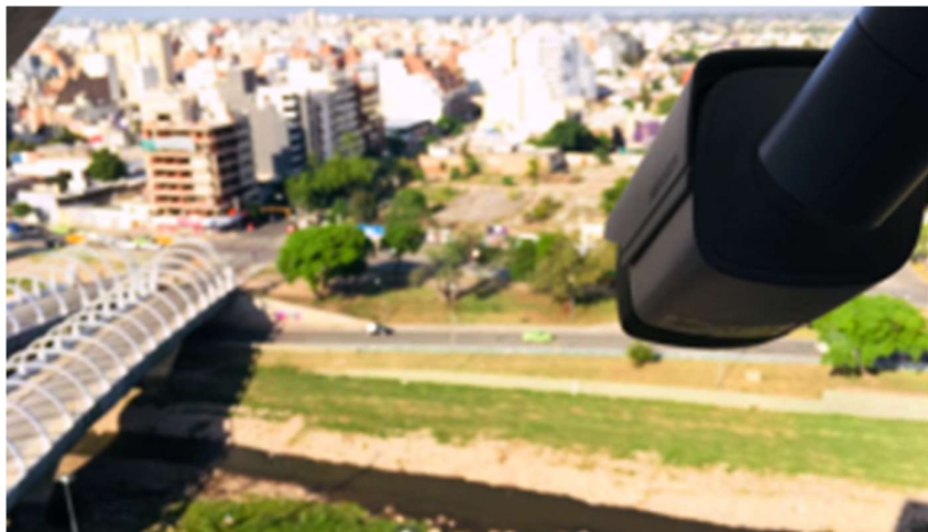
Figura 99: Cámara de la Estación Fija sobre Centro Cívico
