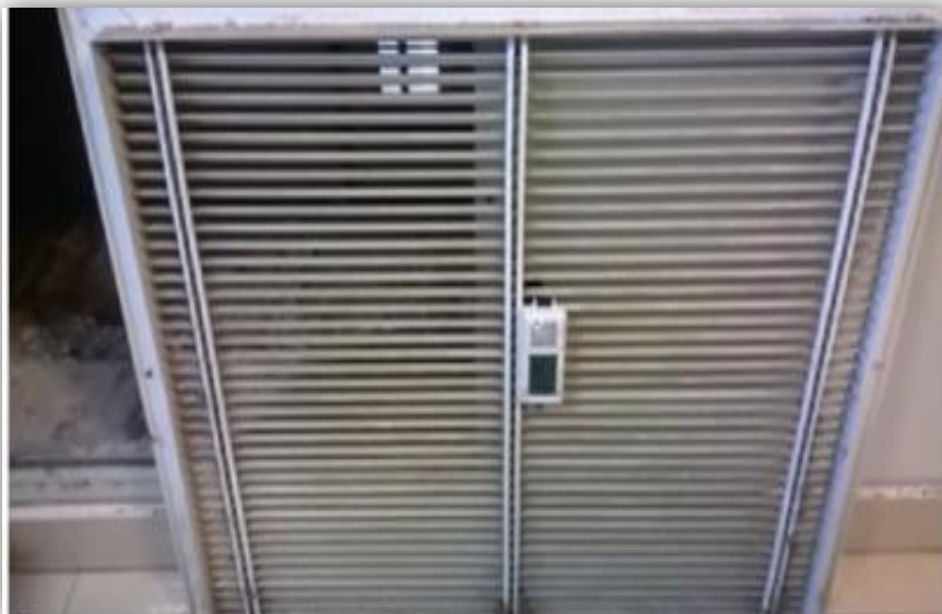
Figura 3-9. Hobo N°1 en el interior de la Reja de Retorno de equipo PB+PA 2
