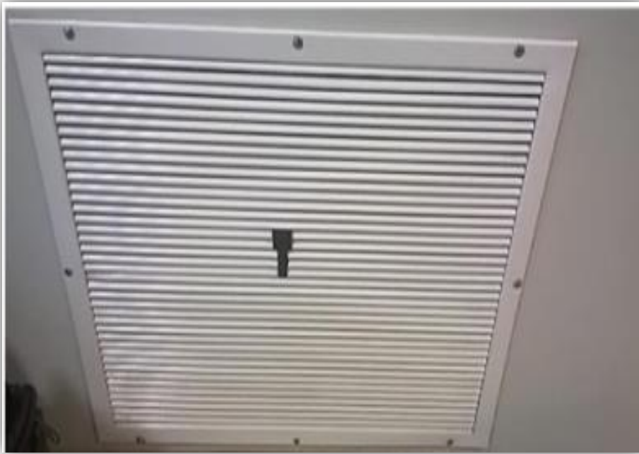
Figura 3-10. Hobo N°1 en el exterior de la Reja de Retorno de equipo PB+PA 2
