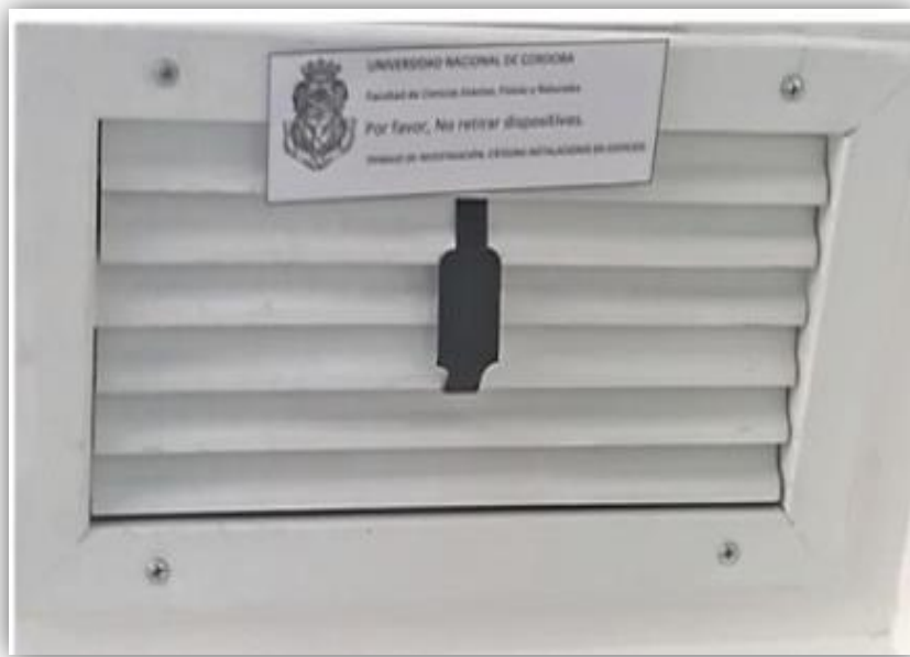
Figura 3-13. Instalación de Hobo N° 3 en el exterior de la Reja de Retorno de Oficina de Administración
