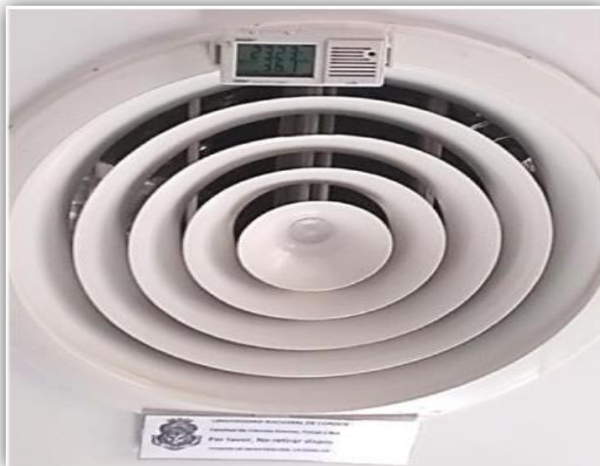
Figura 3-14. Instalación de Hobo N°4 en Reja de Inyección de Oficina de Administración
