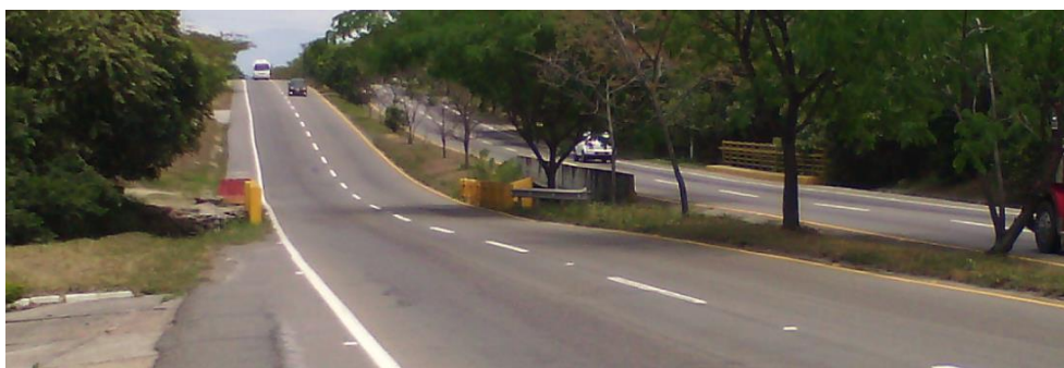
Figura 6.11. Interrupción de la Berma Tramo Fusagasugá Chinauta.
