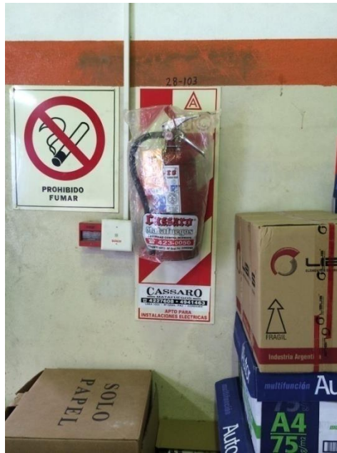
Figura 3.17 - Extintor al costado izquierdo de la Zona A
