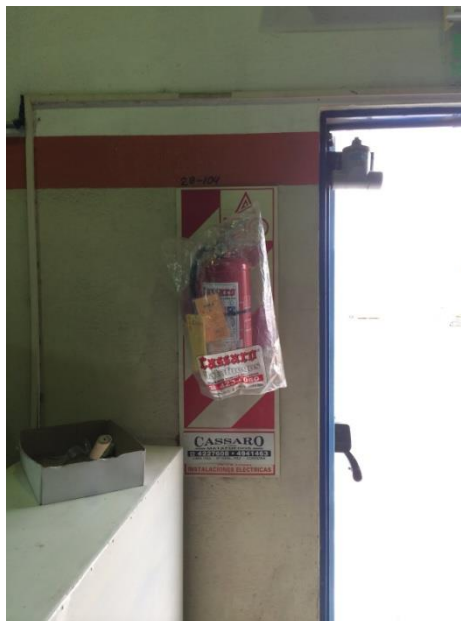
Figura 3.16 – Zona A - Extintor en el ingreso
