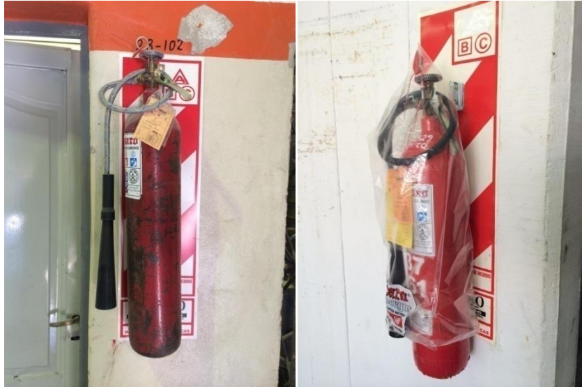
Figura 3.19 – Zona D - Extintores
