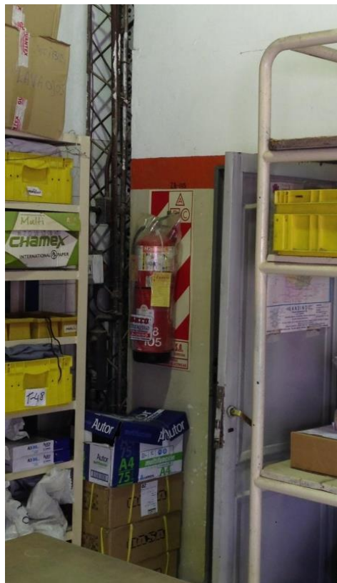
Figura 3.18 – Zona C - Extintor
