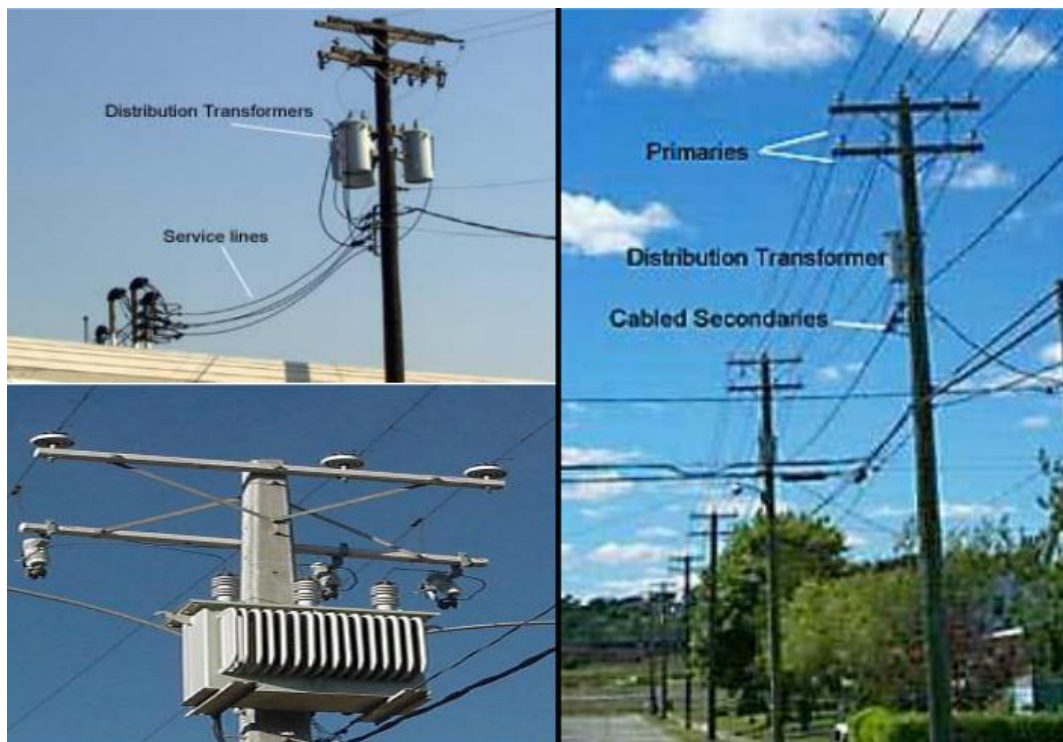
Figura 15 - Distribución de energía eléctrica en Media Tensión
