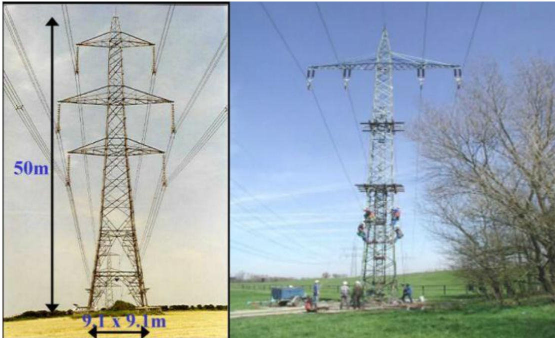
Figura 12 - Torres de transmisión de energía eléctrica en Alta Tensión
