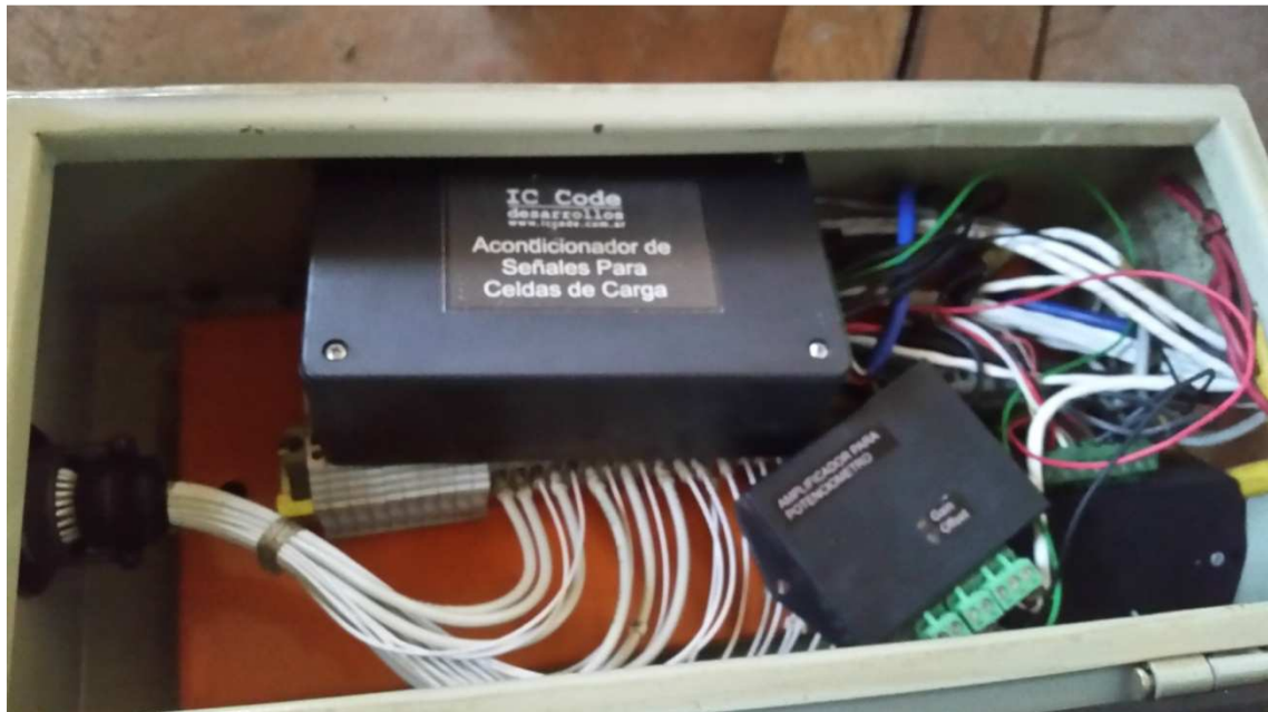
Figura 49: Electrónica y cableados para la celda de carga.
