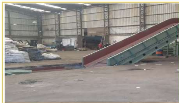
Imagen: Lugar de colocación del Generador de Aire Caliente.
