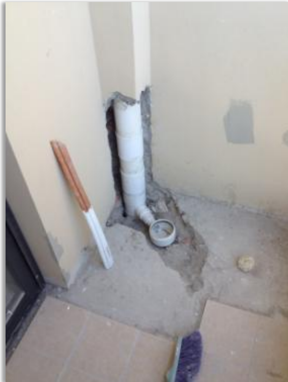
Vista fotográfica de desagüe pluvial en balcón de Gran Depsal II.
