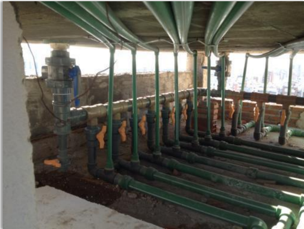
Vista fotografica de colectores y puente de empalme edificio Gran Depsal II
