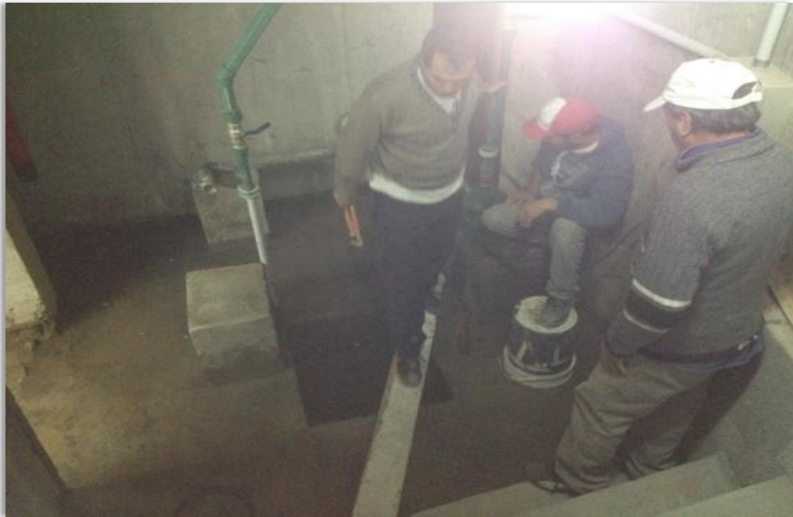
Vista fotográfica de instalación de cuadro de bombas en Edificio Gran Depsal II.
