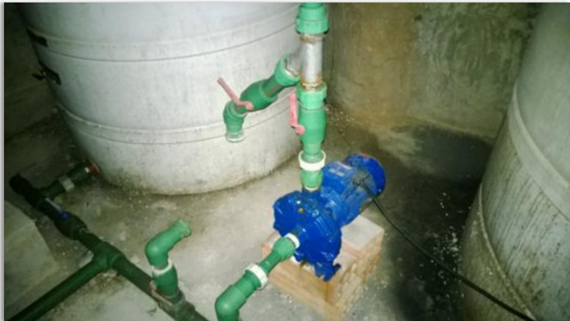
Vista fotográfica de instalación de equipo de bombeo de edificio Depsal X.
