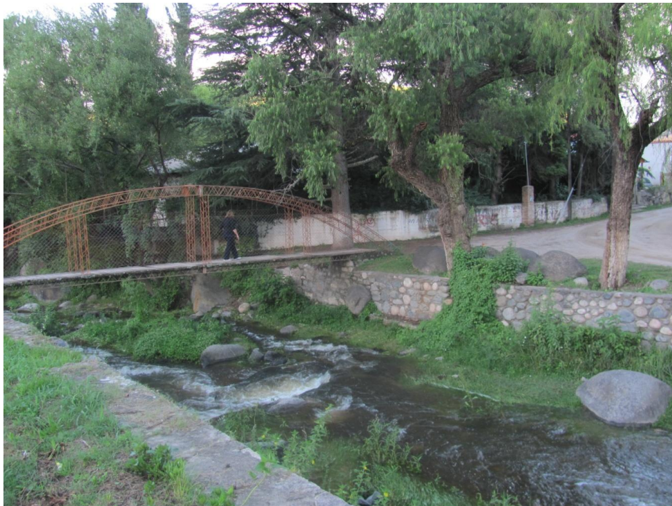
Figura 28. Protección de márgenes aguas abajo de puente próximos a hostería Chicha (Estructura 1)
