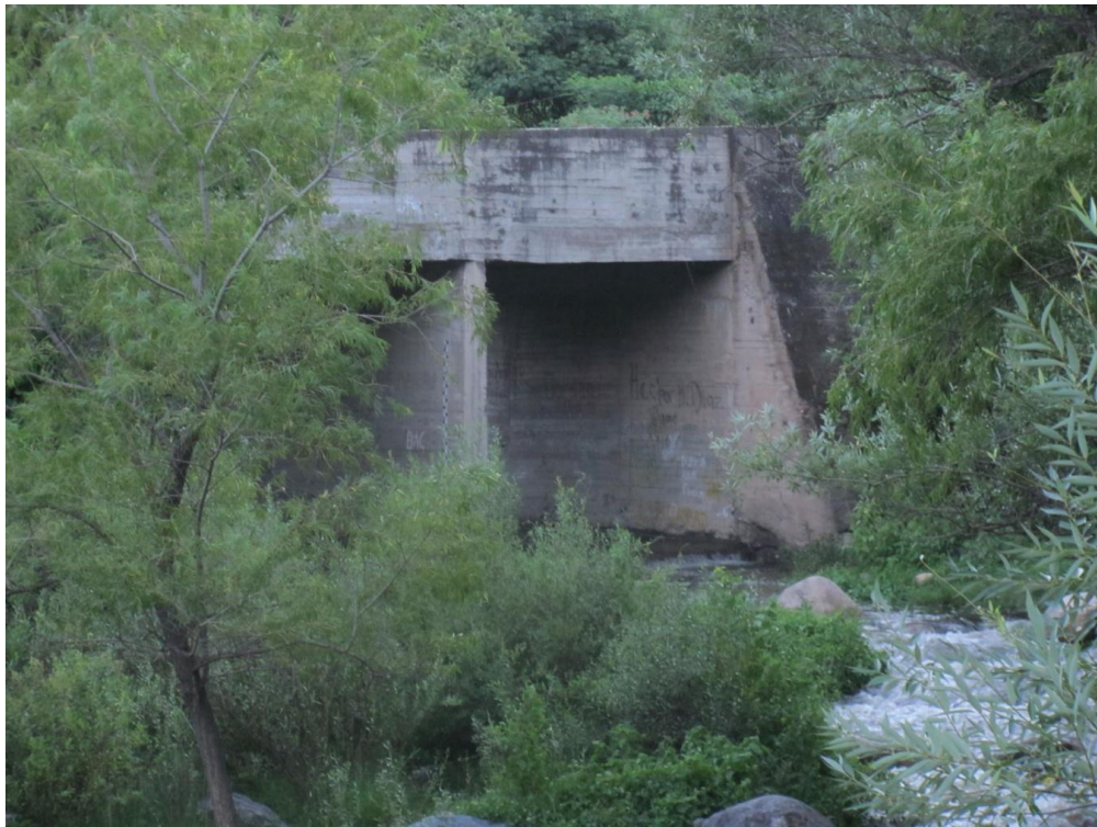
Figura 33. Estructura 4: Puente de ruta 4 sobre río Los Nogales (vista hacia aguas arriba)
