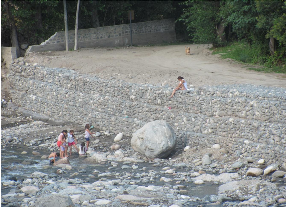
Figura 14. Defensa de gavión realizada aguas abajo del puente próximo a la policía
