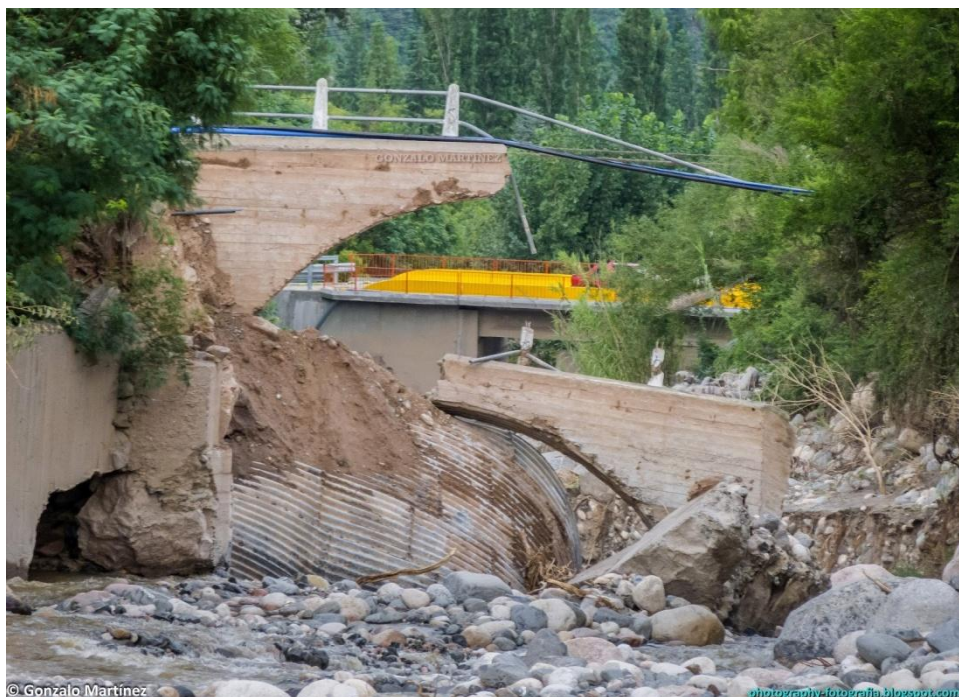
Figura 11. Puente mencionado en la nota. Fuente: http://3.bp.blogspot.com/-McTZilZ9FNM/UwGa9Wz960I/AAAAAAAAAGZw/P36bXke9sRM/s1600/Tragedia+Desastre+Alud+en+El+Rodeo+Creciente+Rio+Ambato+Catamarca+Argentina+Mountains+river(33).jpg . (visto Enero 2.015)
