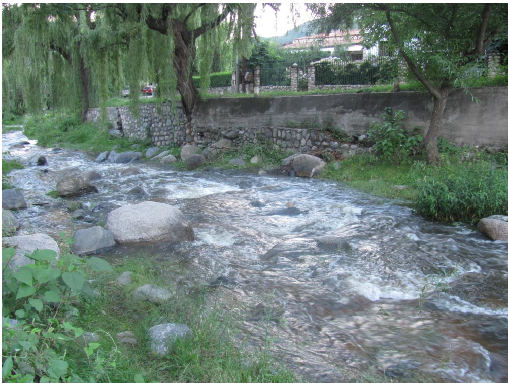
Figura 30. Protección de margen aguas debajo de puente frente a juzgado de paz (Estructura 2)
