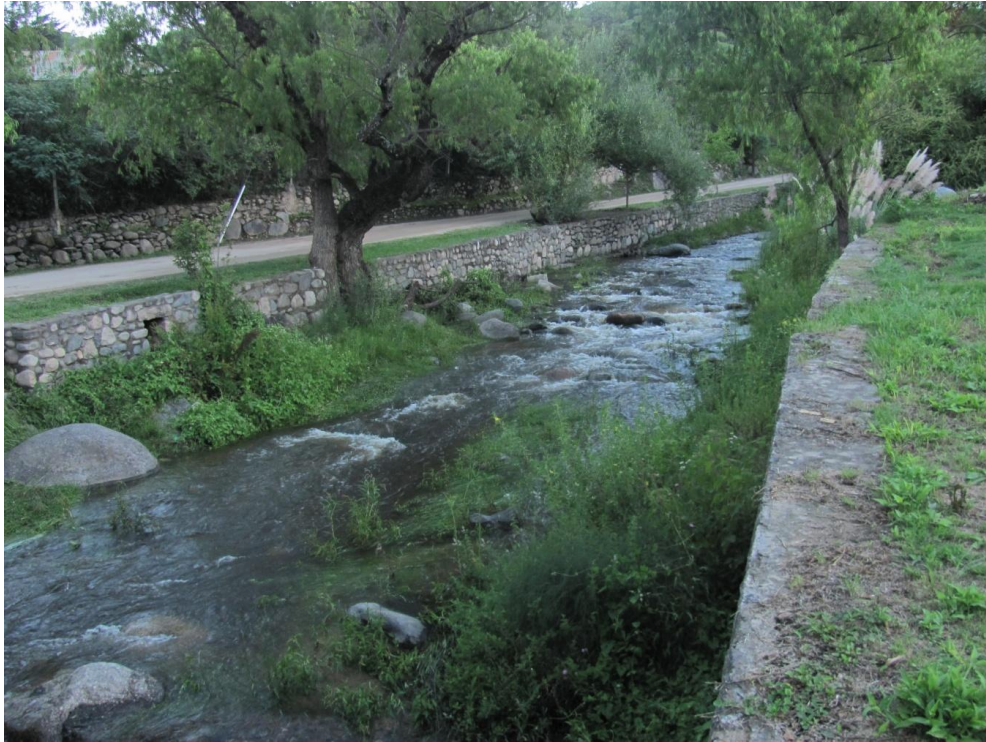
Figura 27. Protección márgenes aguas abajo de puente próximo a hostería Chicha (Estructura 1)
