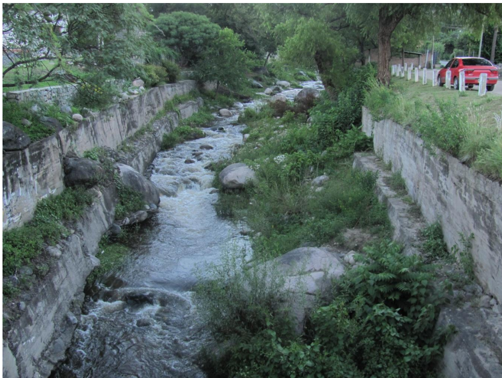
Figura 32. Protección de márgenes aguas arriba del puente próximo a Iglesia de la Candelaria (Estructura 3)
