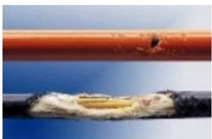
Figura 10: Daño en cables eléctricos provocados por roedores.
