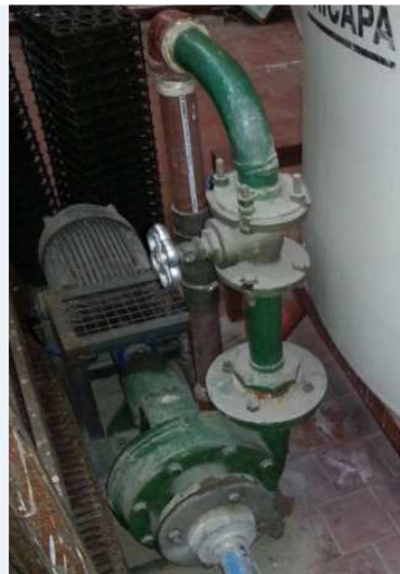
Fig.2.2 – Bomba de agua caliente
