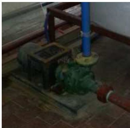
Fig.2.3 – Bomba de agua fría
