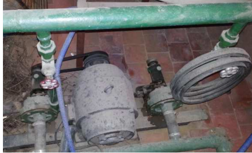
Fig.2.4 – Bomba de recuperación
