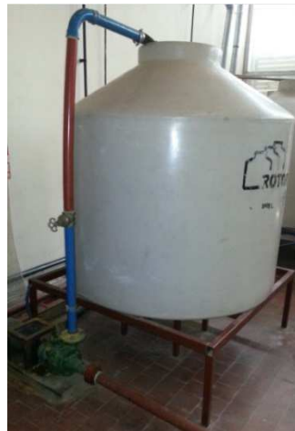
Fig.2.5 – Tanque de agua fría
