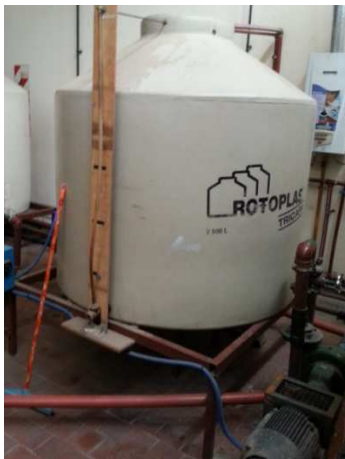
Fig.2.6 – Tanque de agua caliente
