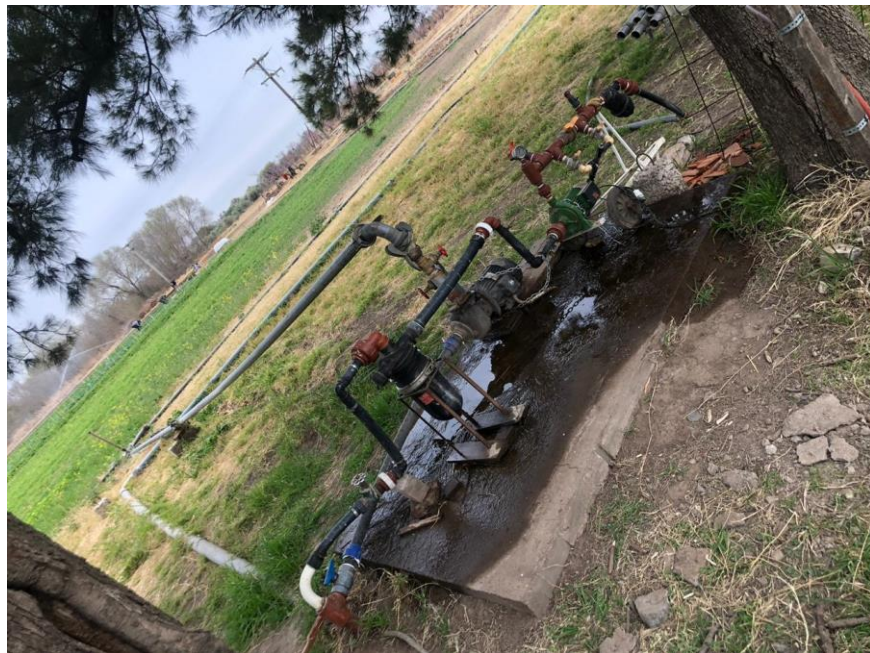
Figura 13: Bomba de Agua del Campo Escuela con diferentes acoples dependiendo el tipo de sistema de riego a utilizar.
