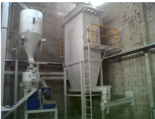
Figura 10: Silo para almacenamiento del afrechillo
