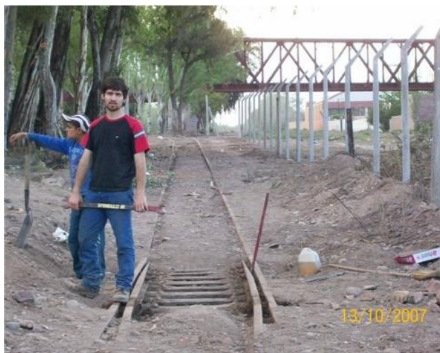
[ Foto de trabajos en el Ramal. Vías de acceso al Frigorífico Regional]
