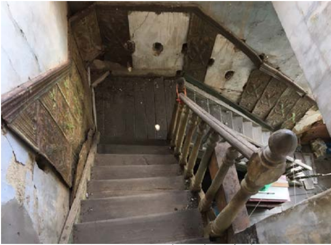
Figura 09: Escadaria do imóvel em péssimas condições. Fonte: Próprio Autor, 2017.
