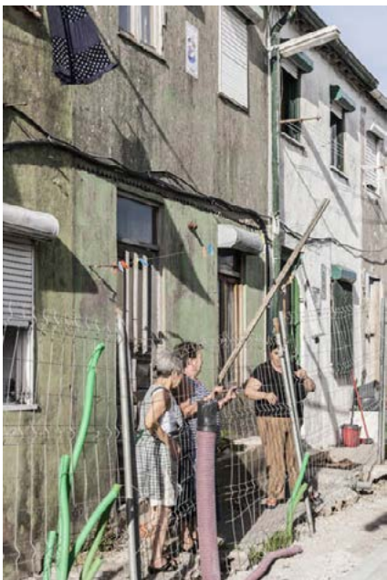
Fotografias 7 – Estaleiro/Obra - 1.ª Fase de Reabilitação da ilha da Bela Vista, 2016. Fonte: Arquivo do Lahb
