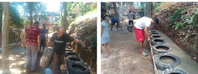
Figura 11: Construção das contenções de taludes e nivelamento da primeira plataforma para as “Férias na Fazendinha”. Fonte: Acervo das autoras, 2018.
