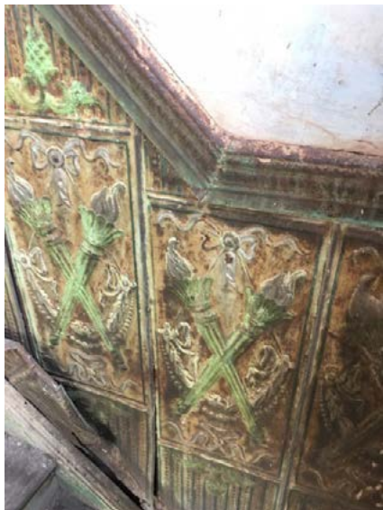
Figura 10: Escadaria do imóvel em péssimas condições. Fonte: Próprio Autor, 2017.
