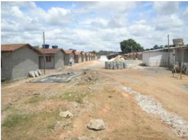
Imagem 2: As casas originais do conjunto, em fase final de construção (2009) Fonte: DE LA MORA et al , 2015, p. 209.
