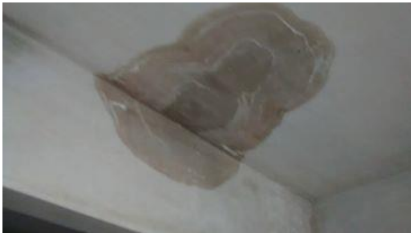
Fig. 22: filtraciones de humedad en departamentos del último piso.
