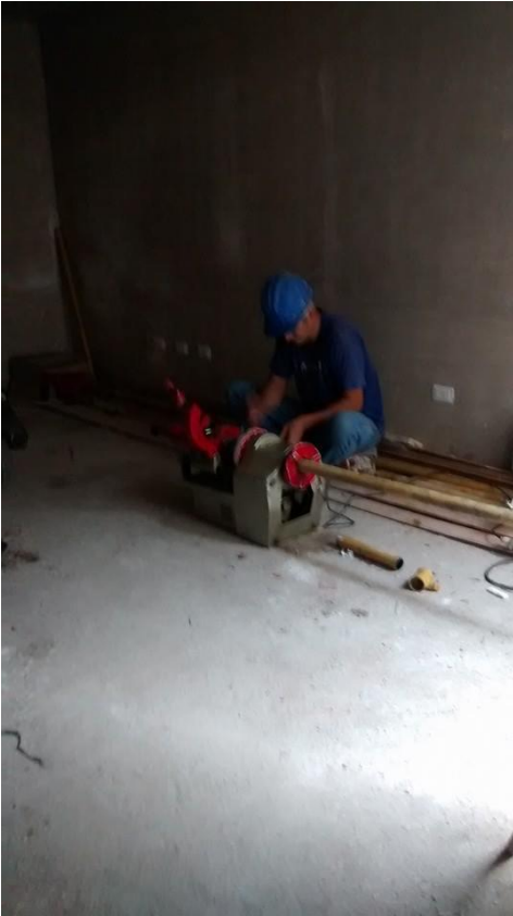
Fig. 26: realización de roscado de caños de montante de gas, como parte de los detalles de terminación.
