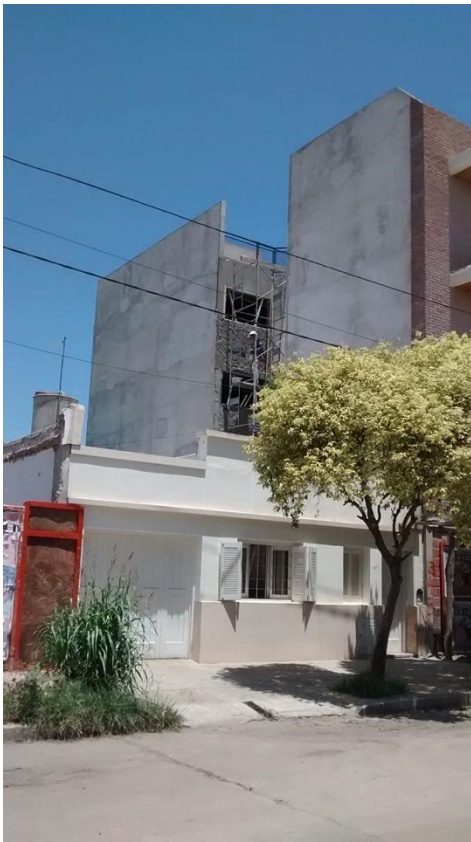
Fig. 20: realización de mampostería y revestimiento de muros de departamentos "B", posterior al orden previsto, por presencia del guinche.
