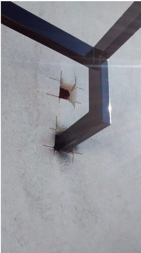
Fig. 24: detalles de mampostería que cubren errores cometidos durante tareas de herrería.
