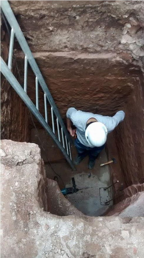
Fig. 12: excavación para subsuelo. Se puede observar el suelo humedecido posterior a días de
