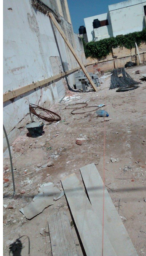
Fig. 10: tareas de replanteo. Se puede observar la tanza que indica el eje de referencia replanteado.
