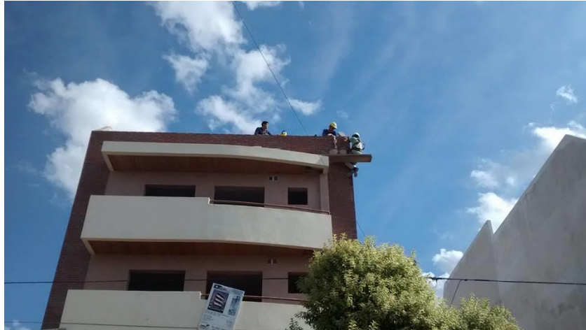
Fig. 18: insuficiencia de medios (andamios) para el avance eficiente en el revestimiento de ladrillo visto en fachada.
