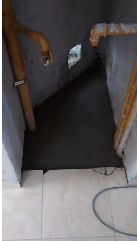
Fig. 27: ejecución de losas de concreto reforzado en montante de gas, como parte de los detalles de terminación posteriores.
