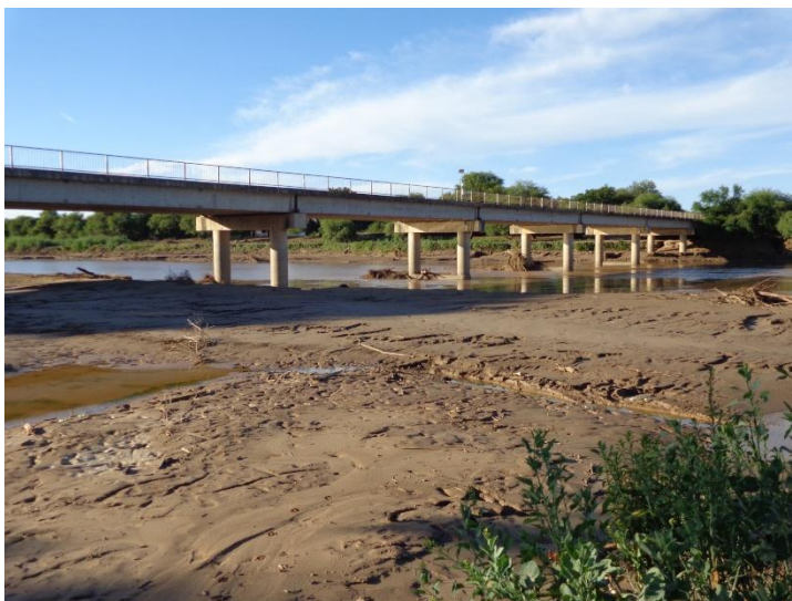
Figura 50.- Puente internacional y Sensor de Nivel (OTT), vista desde aguas abajo, enero 2014 (Cristanchi y Testa Tacchino 2014).
