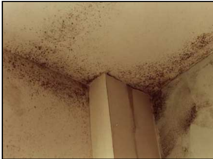
Figura 4.3: Moho y hongos en muros y techos
