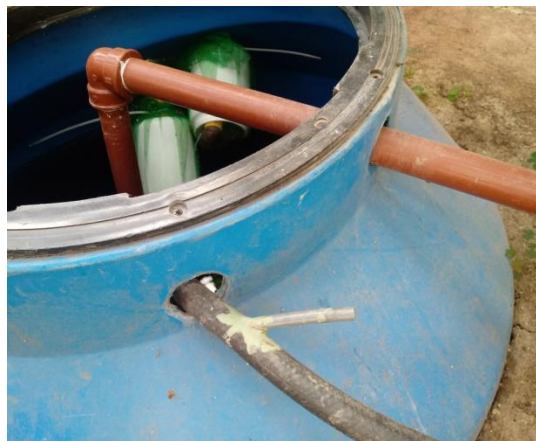
Figura 11: estanque colector con sistema de tuberías de retorno y de administración de solución nutritiva.
