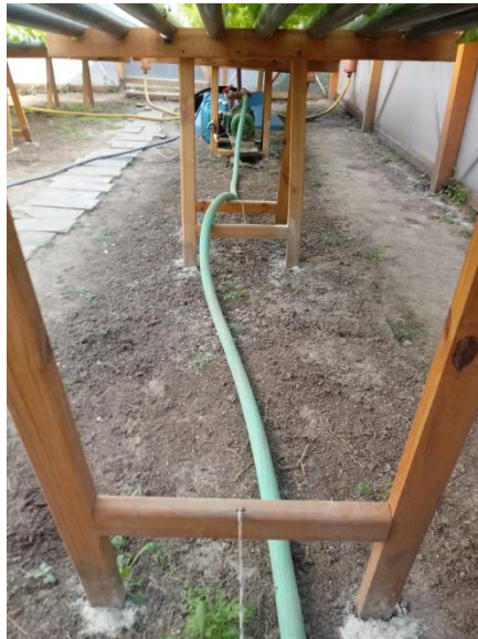
Figura 14: vista inferior del sistema de distribución de la solución nutritiva.
