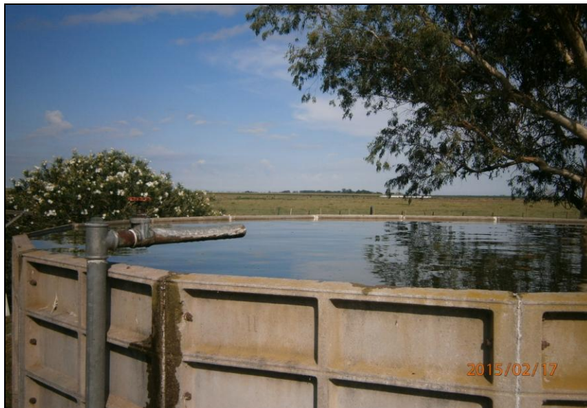
Figura 28: Pérdida persistente de agua en tanque australiano.
