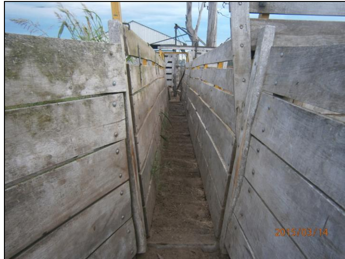
Figura 22: Manga ciega y sin objetos cortantes pero con problemas en el piso.
