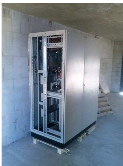
Figura N° 3.16: Tablero General Sitio I y II
