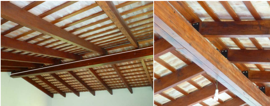
Figura 3: Inspección Visual Deformación
