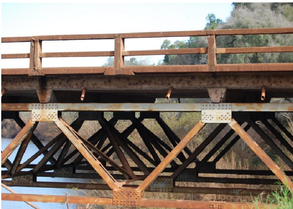
Figura 2.4: Vista lateral del reticulado inferior con los planos de rigidización, nervios transversales, losa y barandas laterales.
