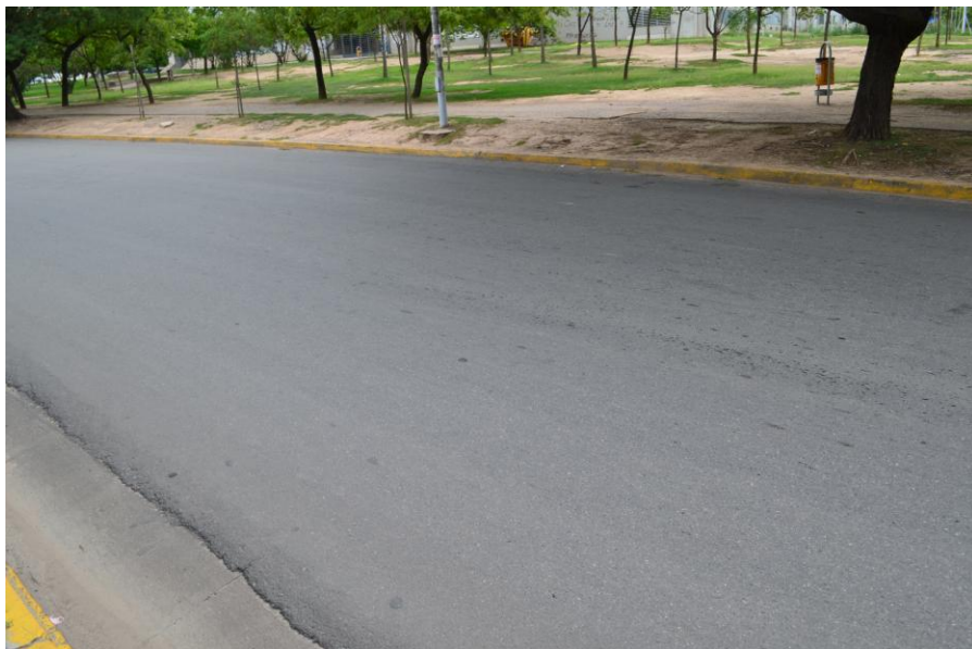
Figura 39: Estado actual pavimento
