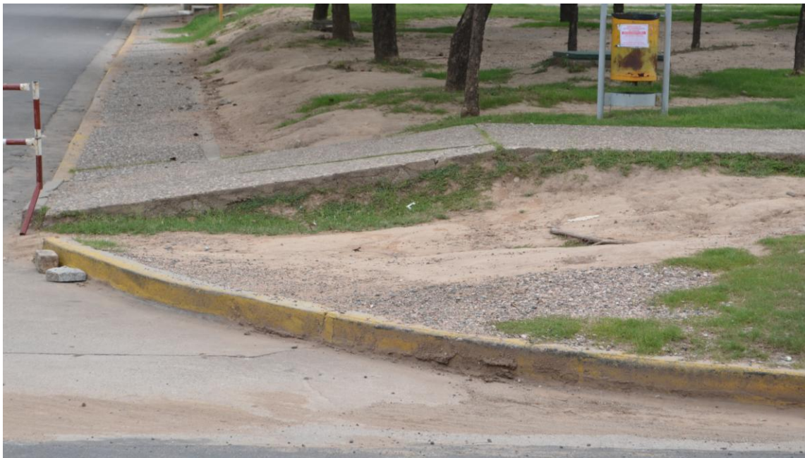
Figura 52: Ubicación de futura rampa de discapacitados con reducción de pendiente de vereda
