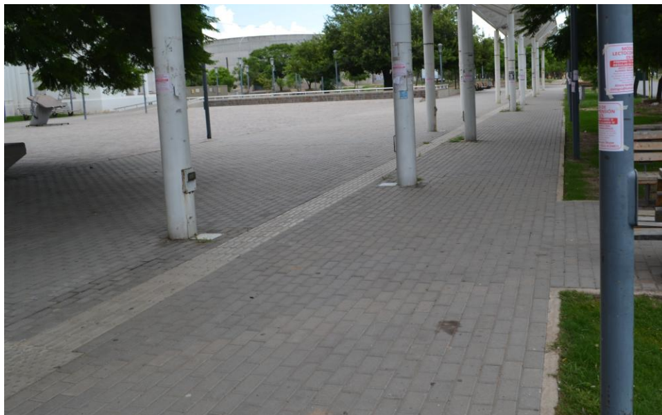
Figura 35: Vereda Actual de Adoquines de Hormigón frente al Pabellón Argentina
