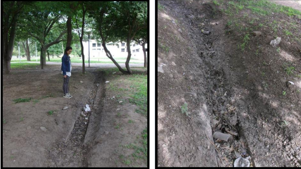
Fig. 17 Falta de Materialización de Canal de Desagüe Existente. Fuente: Elaboración Propia
