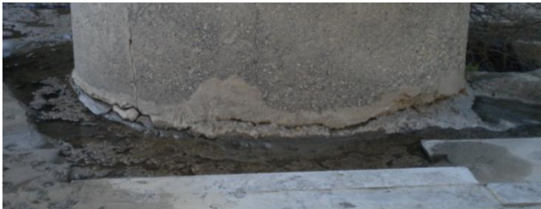
Figura 3.5. Seccionamiento en la base de la pila Norte
