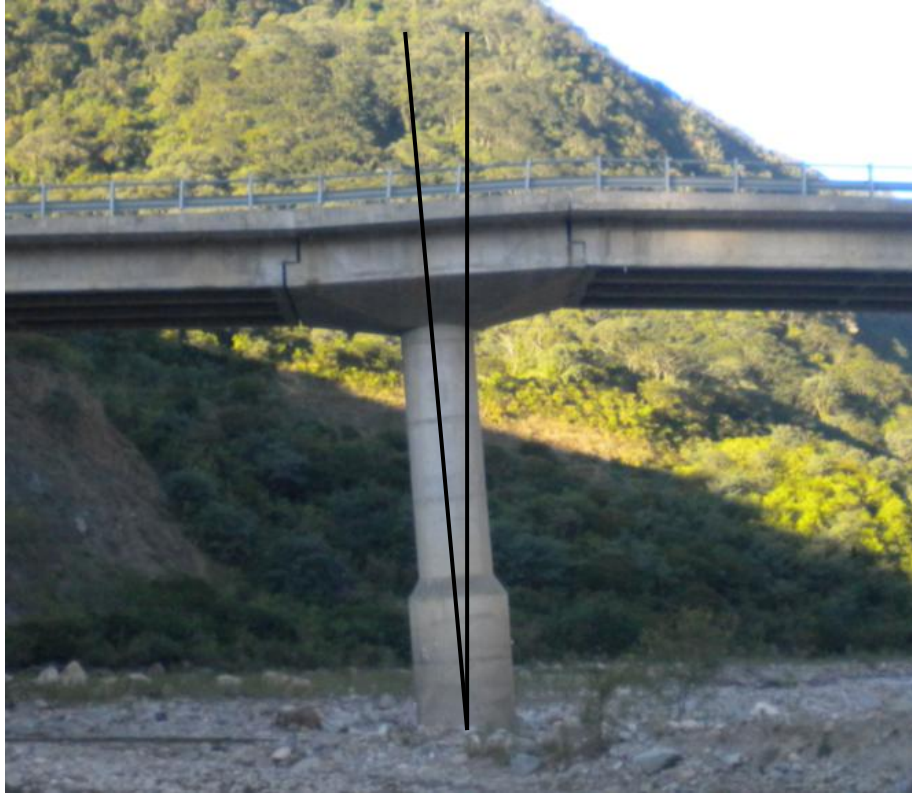
Figura 3.4. Pila Norte, pérdida e ver verticalidad y rotación
