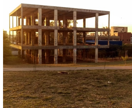
Fig. 42 Fuente: fotografía propia. Obra inconclusa en ciudad universitaria, por años el esqueleto estructural se mantiene intacto, mientras a su alrededor se consolidan obras nuevas provenientes del mismo fondo económico.
