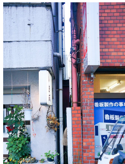
Fig. 163 Recuperada de: https://www.antoniotajuelo.com/es/huecos-entre-edificios-en-japon Imagen del espacio libre entre medianeras obligatorio por ordenanza en prevención ante movimientos sísmicos. En la foto este espacio está utilizado como pleno técnico.
