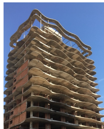
Fig. 5 Fuente: fotografía propia. Arquitectura en la ciudad de Córdoba que muestra la continua búsqueda de referentes en modelos de representación. En la imagen obra inconclusa, paralizada en tareas de construcción.
