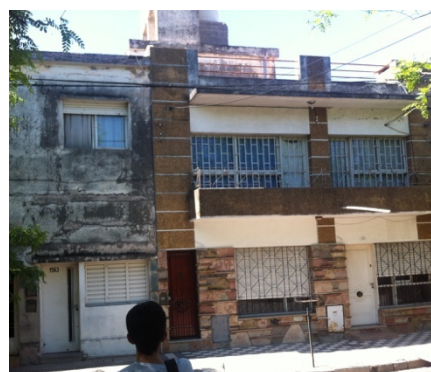
Fig. 296 Fuente: fotografía propia. En la imagen se ven las modificaciones del conjunto por parte de sus habitantes en el tiempo, el cambio sucede dentro de su estructura espacial interior original, sumando ambientes a la vivienda y transformando sus envolventes, con nuevas expresiones ricas en detalles y revestimientos.
