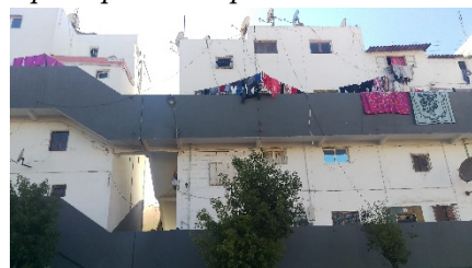
Fig. 289 Fuente: fotografía propia. Conjunto de viviendas de Sémiramis, donde también las terrazas han sido cerradas para completar ambientes interiores.
