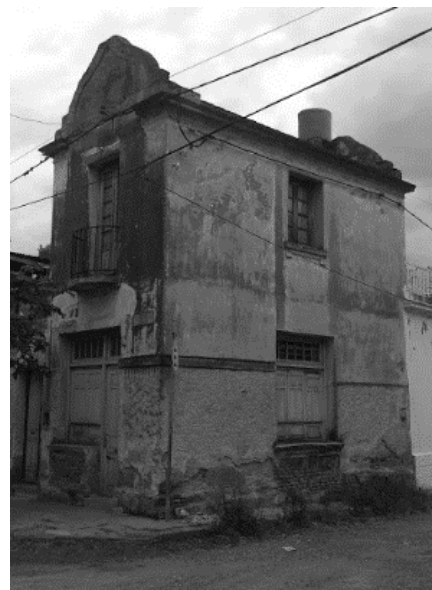
Fig. 291 Fuente: fotografía propia. El conjunto presenta diversidad de viviendas según su ubicación dentro del sector, remarcando su situación particular como ésta en esquina. También se observa el grado de deterioro edilicio y abandono en la protección municipal del patrimonio arquitectónico.
