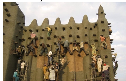
Fig. 33 Fotografía de Julee Khoo. En la imagen se visualiza la reconstrucción anual de la obra de la mezquita de adobe de Djenné, en Malí; la cual se restaura colectivamente todos los años después de la temporada de lluvias. Su construcción en barro se desgasta anualmente y se vuelve a construir con la participación de sus habitantes en un festival comunitario, volviendo a su envolvente nueva y completa otra vez.
