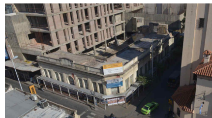
Fig. 79 Recuperada de: https://www.lavoz.com.ar/ Fotografía del CCUNC con demolición parcial de sus preexistencias, conservando algunas de sus envolventes.
