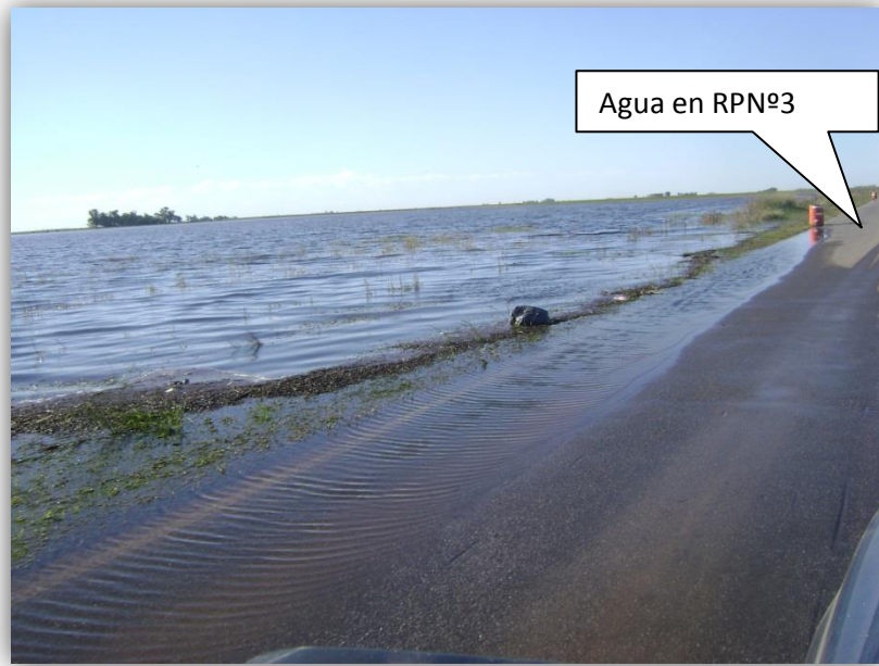
Figura 1.4-13 - Desbordes del Arroyo inundando la Ruta Provincial N°3
