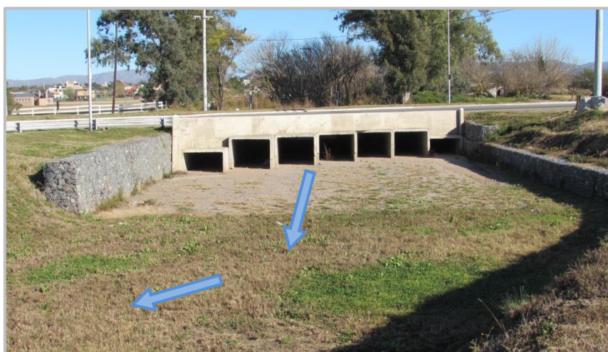
Figura 6.5 – Alcantarilla de cruce del canal bajo RP E-53.
