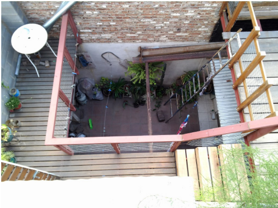
Fotografía de la situación del patio en planta baja posterior a la construcción del balcón y la terraza
