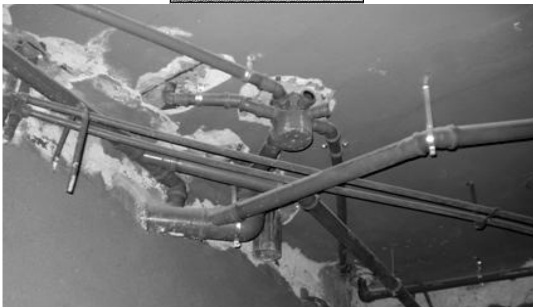
Referencia: instalación cloacal suspendida bajo losa de entrapiso Fuente: Remodelación de vivienda unifamiliar en Río II. Provincia de Córdoba
