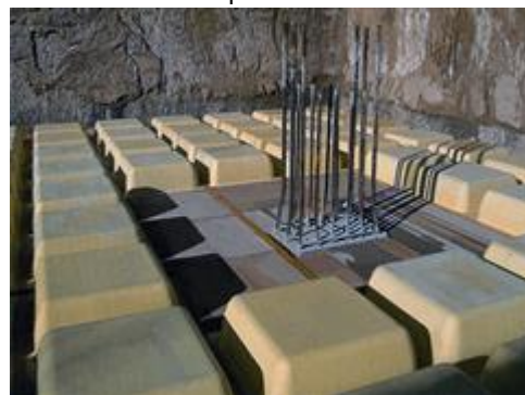
Detalle de zona a macizar para evitar el punzonamiento de la columna
