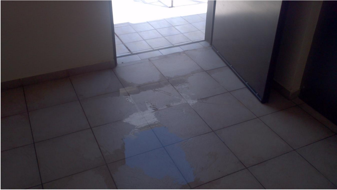
Figura 3.8 Problema de Pendiente en el solado
