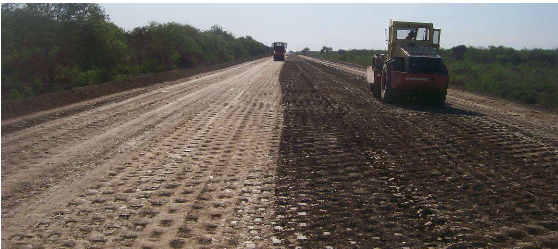
Fig.4.157: Sellado con compactador neumático mientras un rodillo pata de cabra termina con la compactación de la capa. Sección III.
