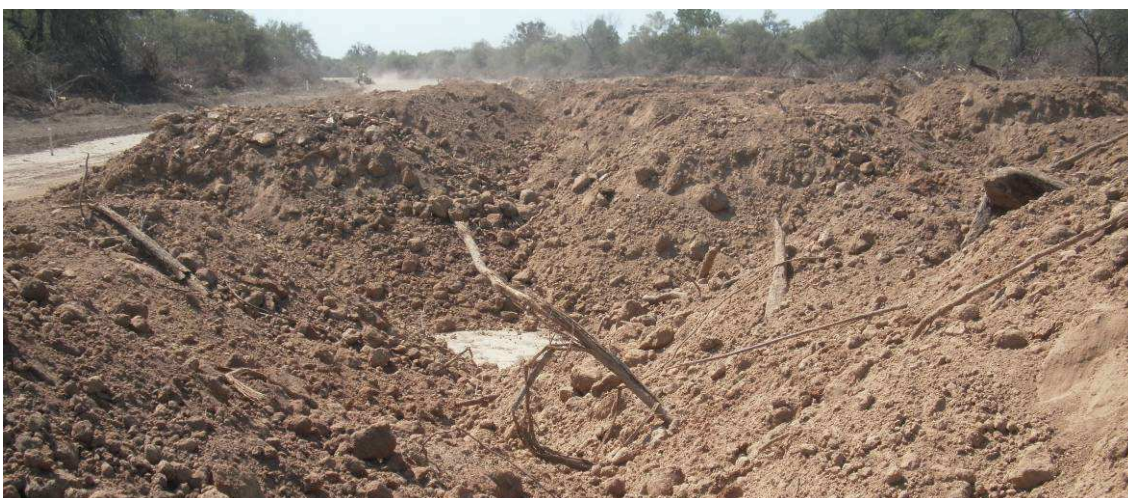
Fig.4.123: Presencia de ramas y raíces de gran tamaño en montículos de suelo descargados en Progresiva 12+500 Sec.III.
