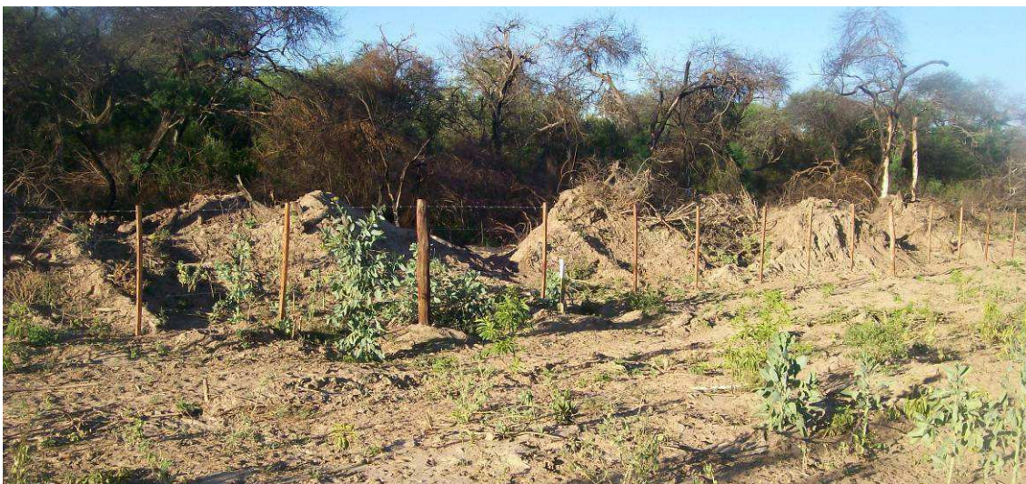
Fig.4.52: Mal espaciados los balancines y falta varilla central. Sec III desde Prog. 2+000 a 3+500 lado derecho.
