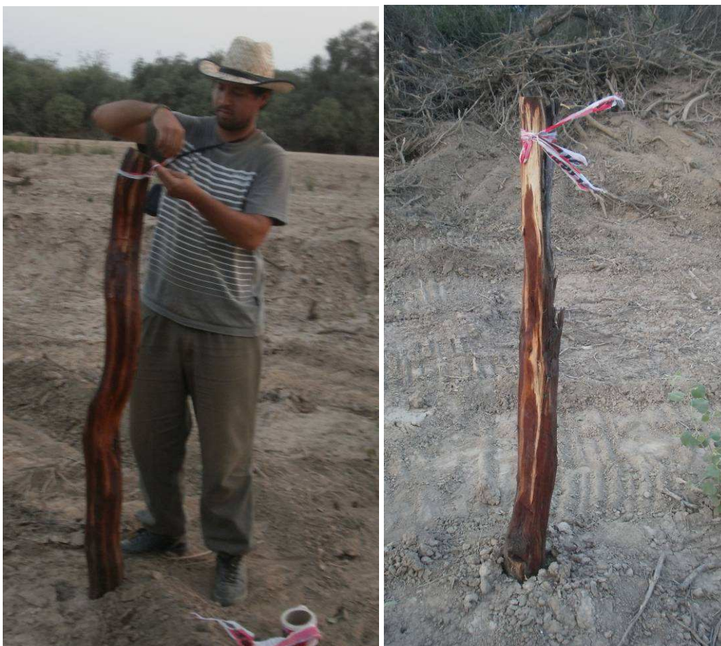
Fig.4.65 (Izq.): Rechazando poste por tener más de una curvatura y por no cumplir exigencia de diámetros mínimos. Este poste fue previamente descartado en obrador.
