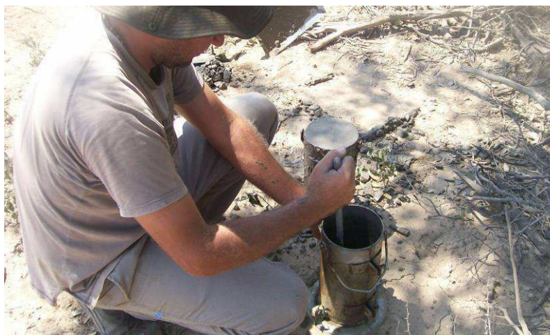
Fig.4.93: Llenado de probetas para control de resistencia del hormigón durante hormigonado de tabiques de alcantarilla en Prog. 30+000. Sec. II.
