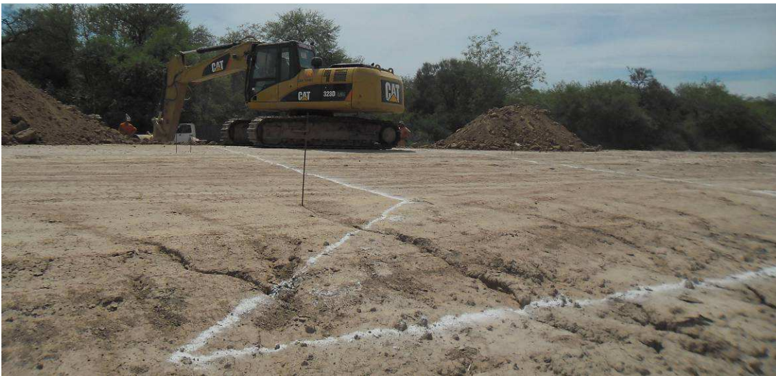
Fig.4.76: Retroexcavadora Caterpillar 323D ejecutando la apertura en terraplén para emplazamiento de alcantarilla. Prog. 10+900 Sec. II.
