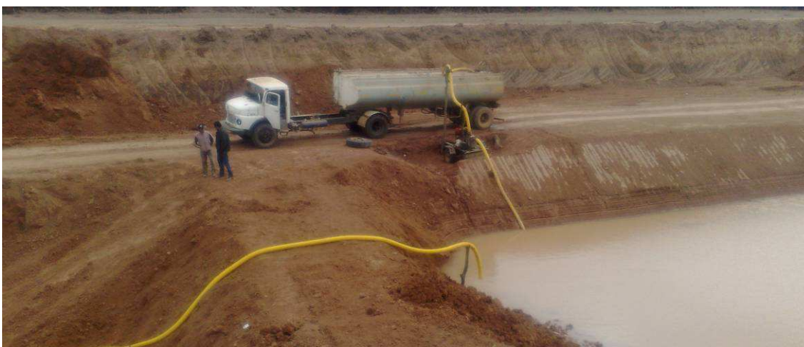
Fig. 8.37: Carga de camión regador desde la reserva de agua, ex préstamo de suelo.
