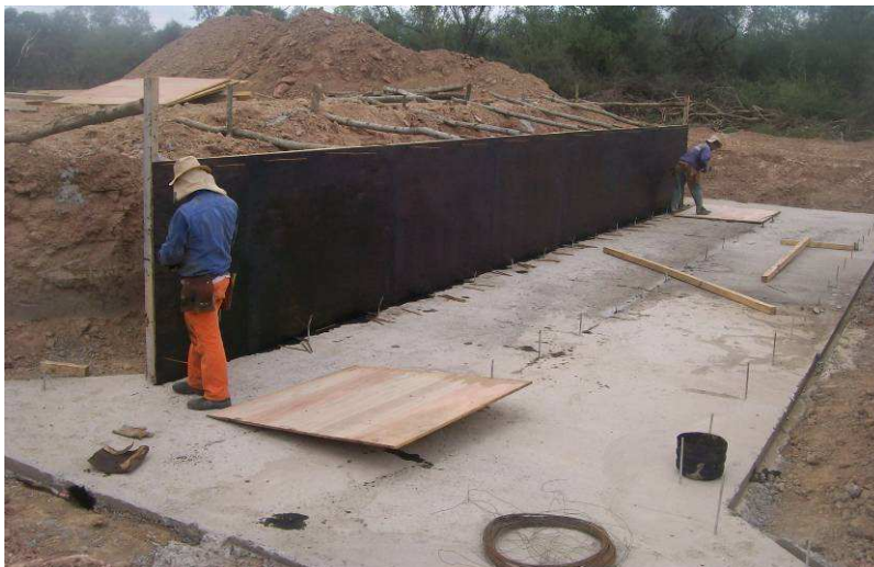
Fig.4.95: Encofrado de muros laterales de alcantarilla de dos bocas en Prog. 5+300 Sec. II.
