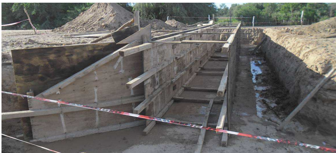
Fig.4.96: Encofrado de muros laterales de alcantarilla de una boca en Prog. 14+535 Sec. III.
