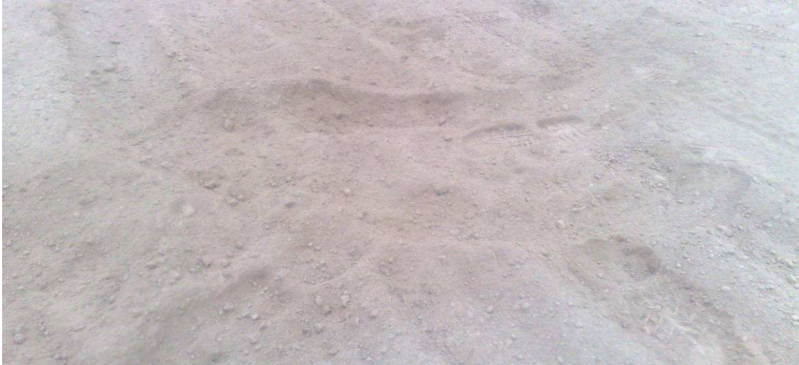
Fig.4.158: Sector de cancha deteriorado. Progresiva 22+200 Sección II.
