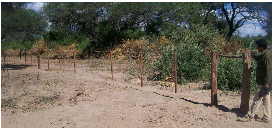
Fig.4.53: Alambrado Sec. III Prog.0+000 a 3+300 falta varilla central, lado izquierdo.
