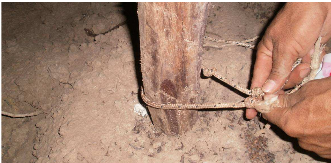
Fig.4.73: Poste rechazado por no cumplir con el diámetro mínimo en la base y en la punta. Prog. 0+000 y 1+500 lado derecho, Sec III.
