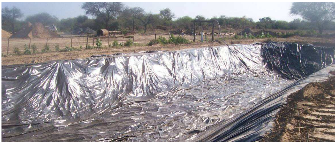
Fig.4.21: Fosa para reserva de agua por bombeo en Sección II. Aquí se observa la membrana impermeable y hacia el fondo de la imagen la perforación de donde se extrae el agua.
