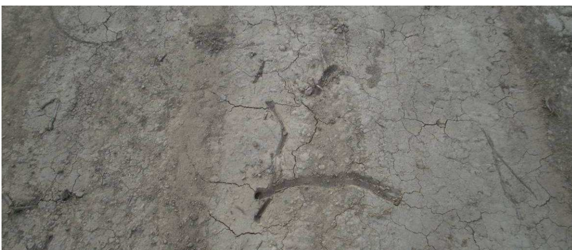
Fig.4.134: Marca sobre la superficie de la base de asiento dejada por la presencia de ramas o raíces. Prog. 12+700 Sec.III.
