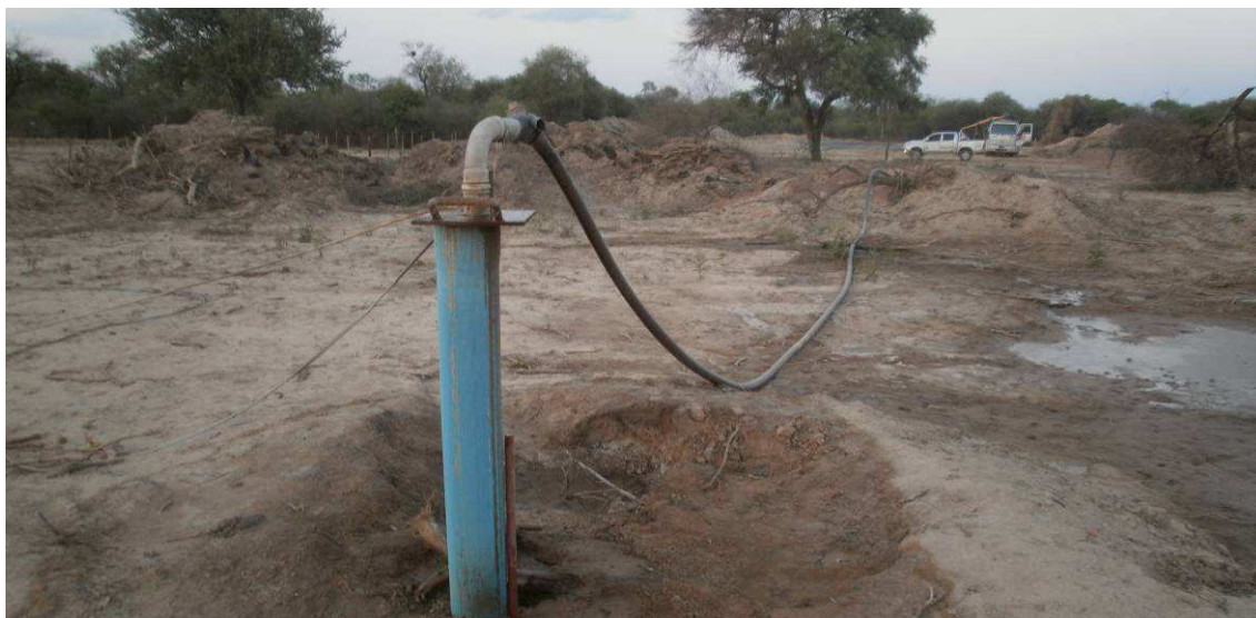
Fig.4.18: Perforación que abastece de agua a la reserva ubicada en cercanías al obrador de Lamadrid.
