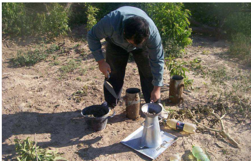
Fig.4.91: Ensayo de asentamiento antes de hormigonar tabiques de alcantarilla en Prog. 30+000. Sec. II.
