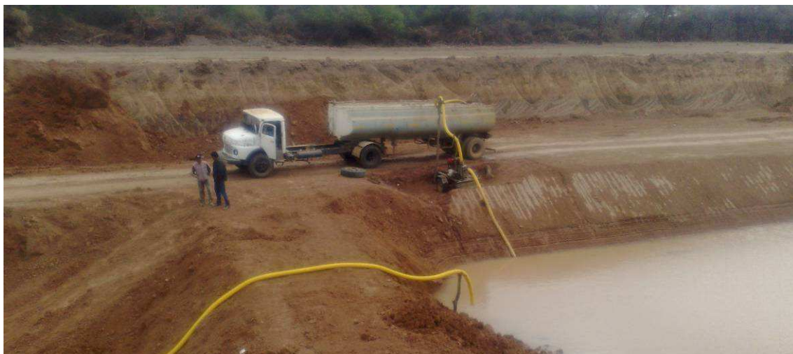
Fig.4.32: Operación de carga de agua a camión regador cisterna en la Sección II.
