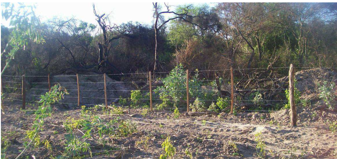
Fig.4.54: Alambrado Sec. III Prog.0+000 a 3+300 falta varilla central, lado izquierdo.
