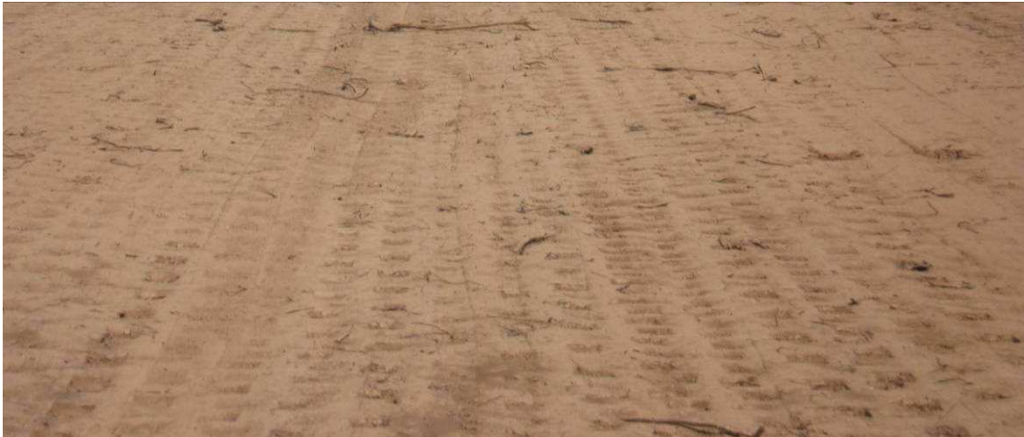
Fig.4.127: Presencia de ramas y raíces sobre base de asiento compactada. Progresiva 12+700 Sec.III.
