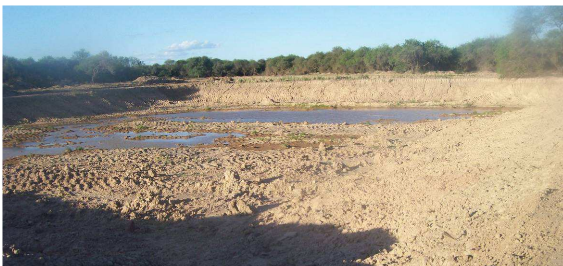
Fig.4.17: Préstamo en Sección I. Se observa cómo, luego de una lluvia, se empieza a acumular el agua en el fondo de la fosa debido a su baja permeabilidad.
