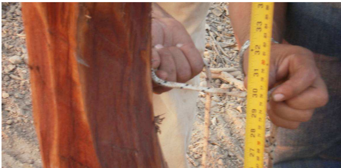
Fig.4.61: Poste con flecha mayor a 10cm. Prog. 0+000 y 1+500 lado derecho, Sec III.
