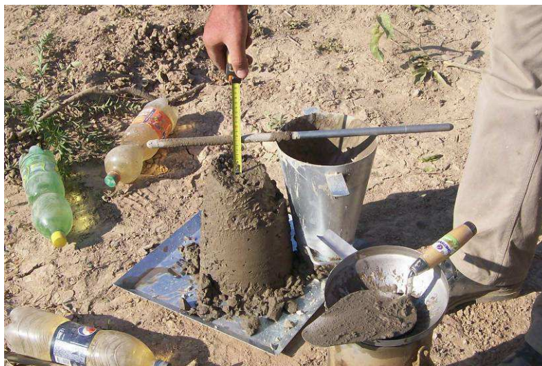
Fig.4.92: Ensayo de asentamiento antes de hormigonar tabiques de alcantarilla en Prog. 30+000. Sec. II.
