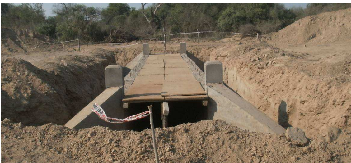
Fig.4.103: Encofrado de losa superior de alcantarilla de una boca. Prog. 5+700 Sec. II.
