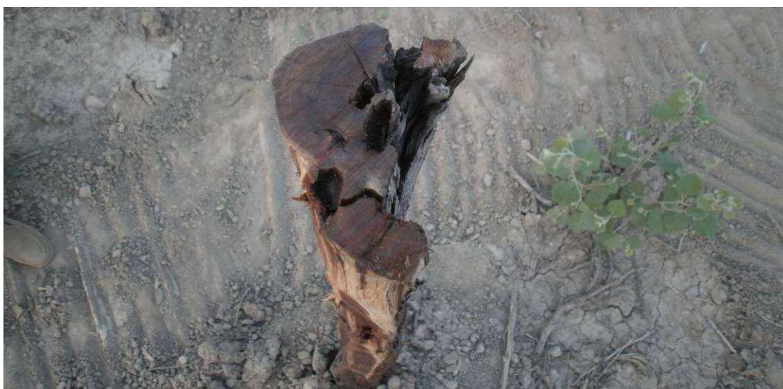
Fig.4.59: Poste en mal estado rechazado por inspección previamente en obrador. Postado entre Prog. 0+000 y 1+500 lado derecho, Sección III.
