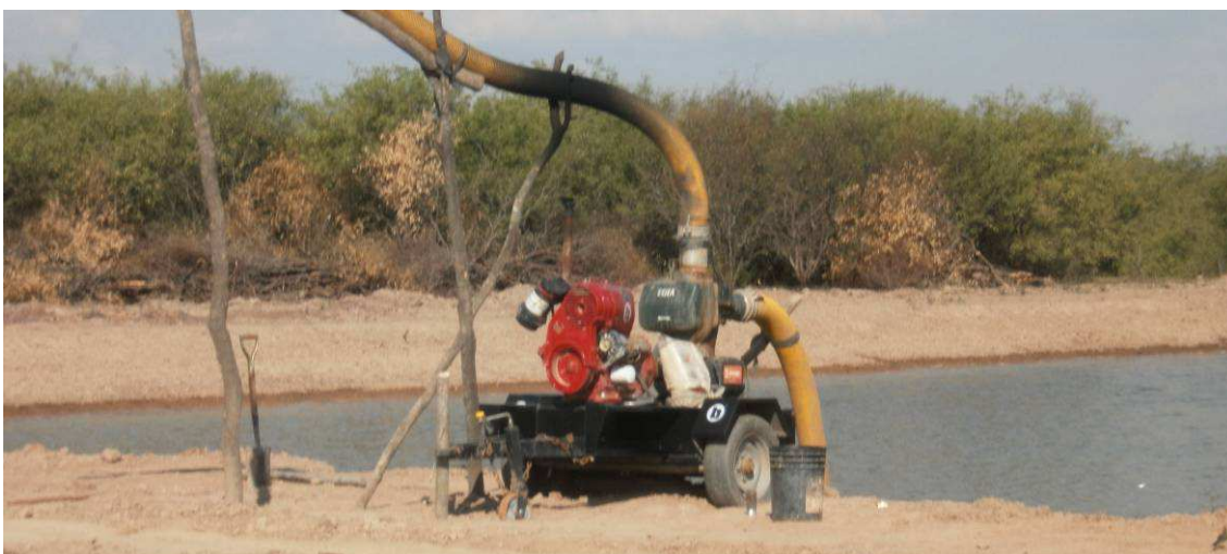
Fig.4.25: Bomba para cargar el agua de la reserva en la Sección III, en los camiones regadores cisternas afectados a dicho tramo.
