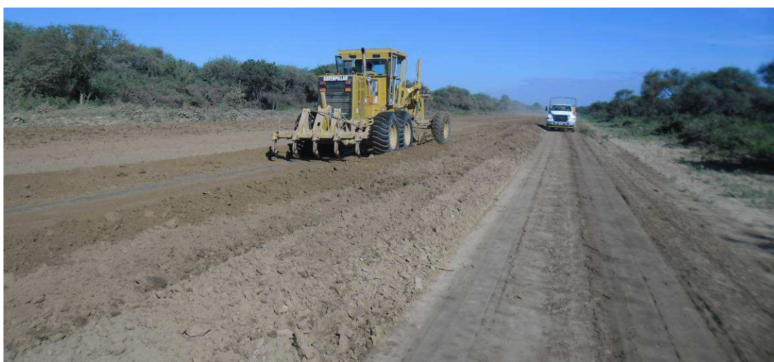
Fig.4.141: Motoniveladora 140H. Trabajando sobre la distribución del suelo en cancha. Prog. 24+400 Sec. II.
