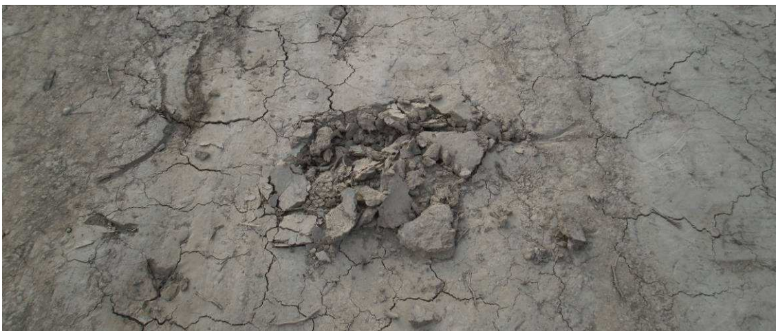
Fig.4.133: Marca sobre la superficie de la base de asiento dejada por la presencia de ramas o raíces. Prog. 12+700 Sec.III.
