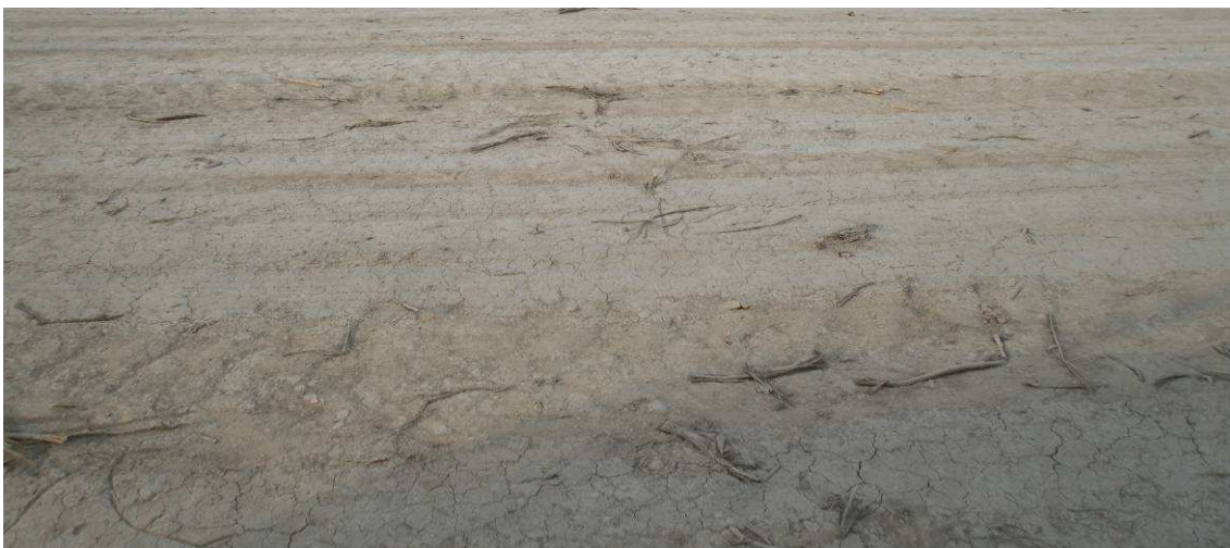
Fig.4.128: Presencia de ramas y raíces sobre base de asiento compactada. Progresiva 12+700 Sec.III.
