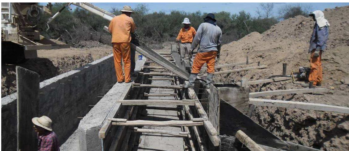
Fig.4.102: Hormigonado de muro lateral de alcantarilla de dos bocas. Prog. 10+505 Sec. II.
