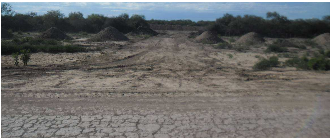
Fig.4.186: Ausencia total de carteles indicadores en ingreso a préstamo. Progresiva 30+950. Sección II.
