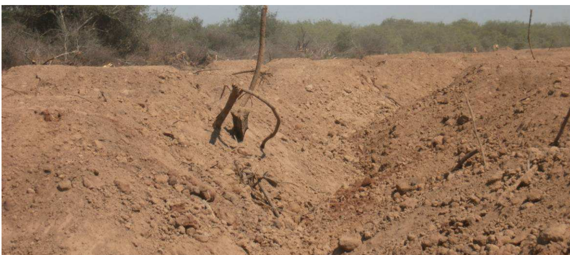
Fig.4.125: Presencia de ramas y raíces de gran tamaño en montículos de suelo descargados en Progresiva 12+500 Sec.III.
