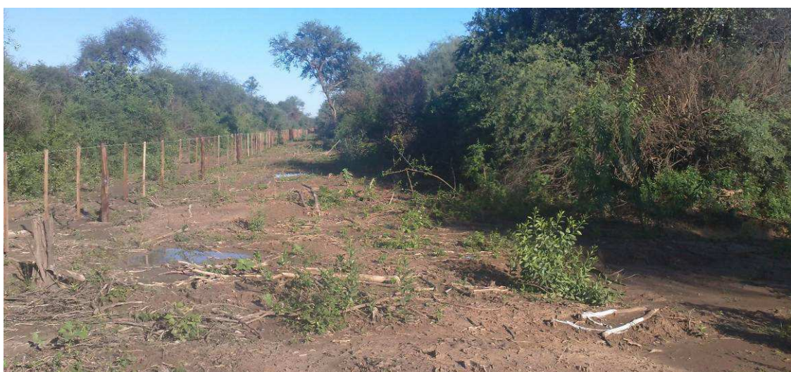
Fig.4.51: Alambrado Sec III Prog. 0+000 a 3+300. Falta varilla central para terminar lado izquierdo.
