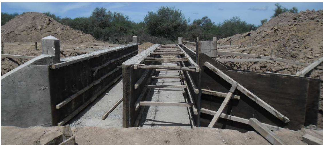
Fig.4.101: Alcantarilla de dos bocas con un muro lateral sin hormigonar. Prog. 10+505 Sec. II.
