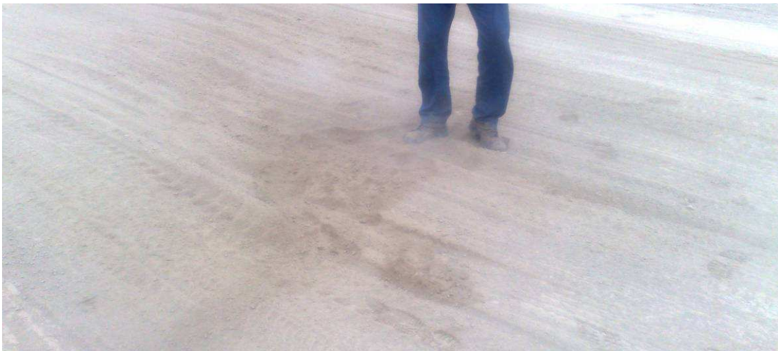
Fig.4.159: Sector de cancha deteriorado. Progresiva 22+200 Sección II.
