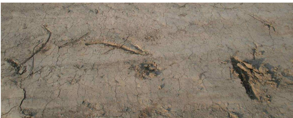
Fig.4.132: Marca sobre la superficie de la base de asiento dejada por la presencia de ramas o raíces. Prog. 12+700 Sec.III.
