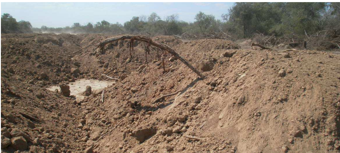
Fig.4.121: Presencia de ramas y raíces de gran tamaño en montículos de suelo descargados en Progresiva 12+500 Sec.III.
