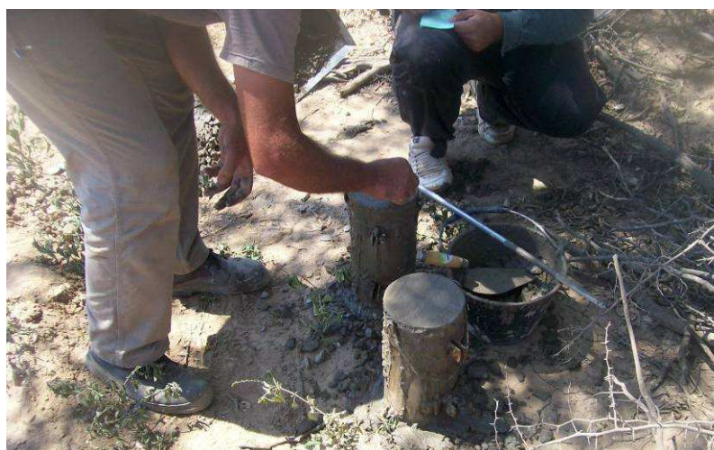
Fig.4.94: Enrasado de probetas para control de resistencia del hormigón durante hormigonado de tabiques de alcantarilla en Prog. 30+000. Sec. II
