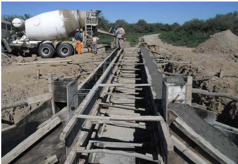
Fig.4.98: Hormigonado de muros laterales de alcantarilla de una boca en Prog. 30+000 Sec. II.
