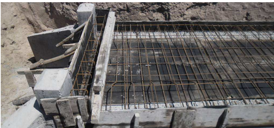
Fig.4.105: Armadura de losa superior de alcantarilla de una boca. Prog. 5+200 Sec. II
