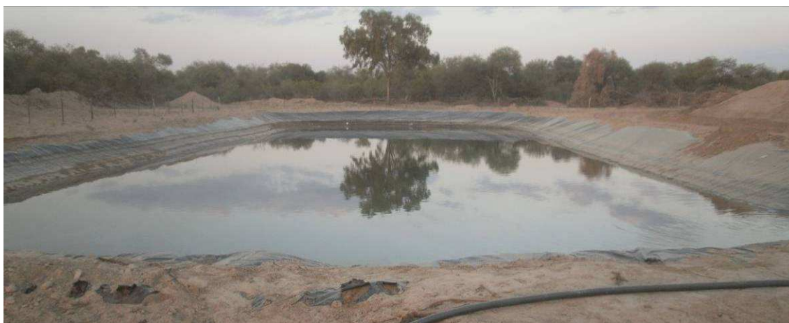
Fig.4.19: Reservorio de agua de JCR en Lamadrid. Se observa que la fosa está cubierta con una membrana plástica para evitar la pérdida de agua por percolación.
