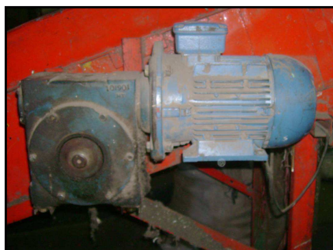
Ilustración 9.16- Motor y caja de transmisión de cinta transportadora de alimentación.
