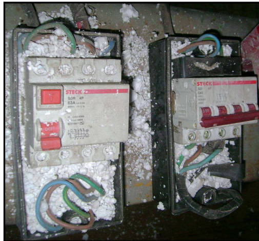
Ilustración 9.22- Comandos de accionamiento y protecciones de trituradora de "Telgopor".
