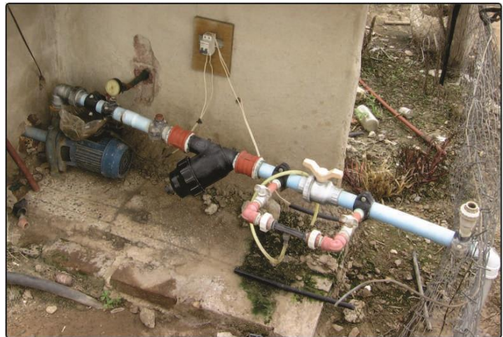
FIGURA 4.8: Equipamiento de bombeo para distribución interna del sistema de goteo.
