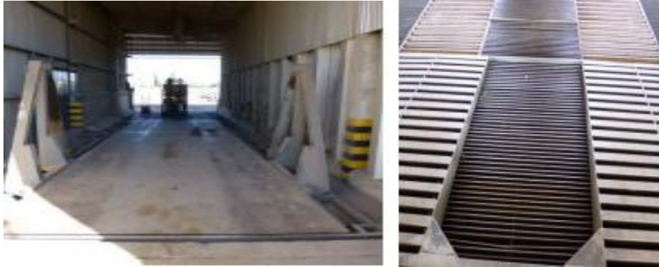
Figura 9: Plataforma y rejilla de descarga
