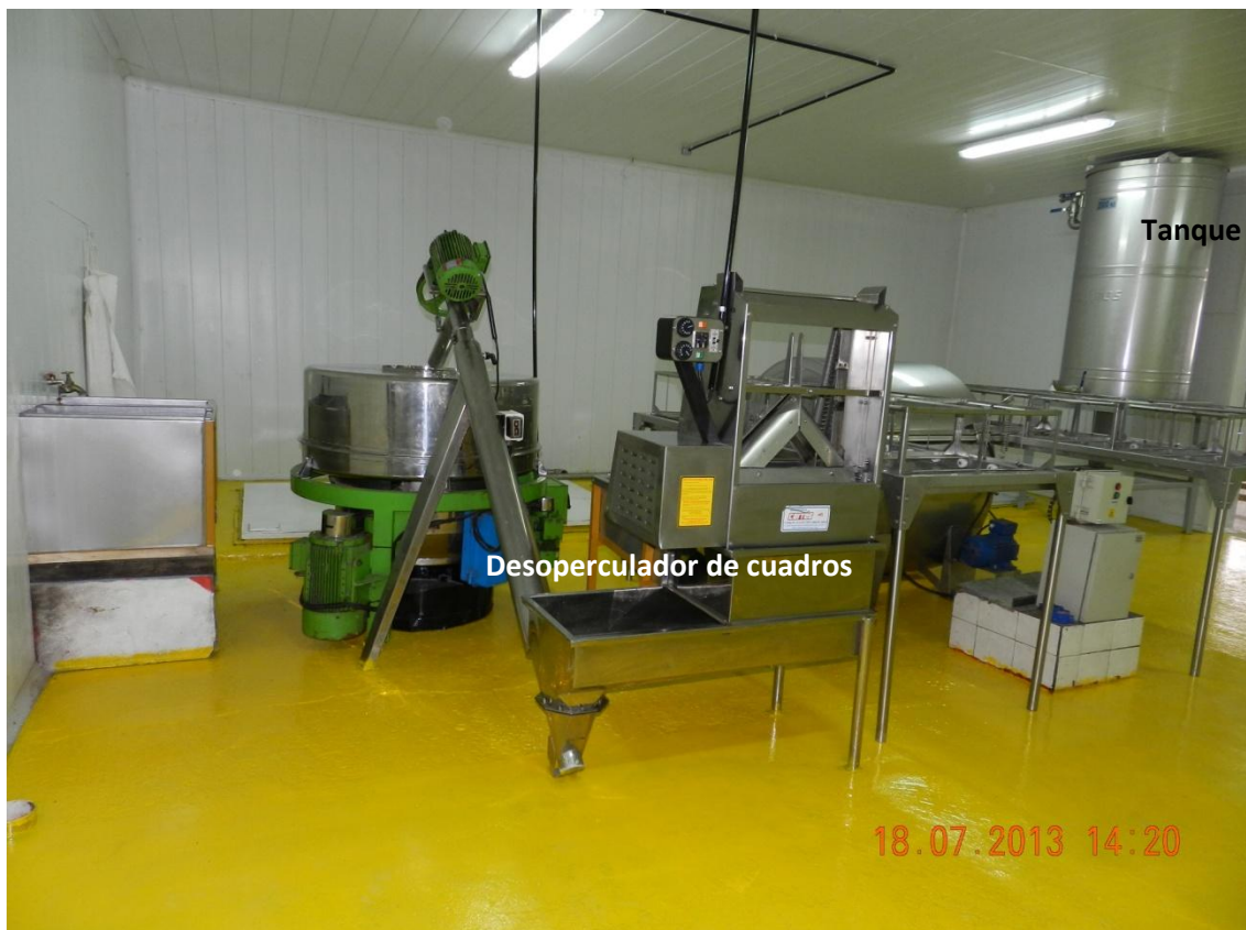
Figura 13: Sala de extracción del establecimiento Santa Eufemia.
