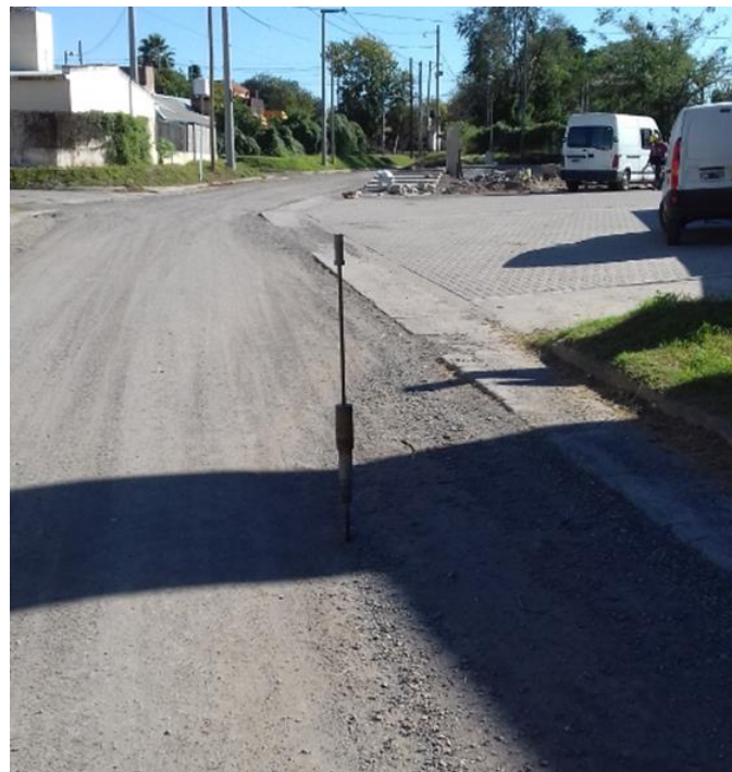
Imagen 40 - Ensayo DCP N°1 realizado sobre "bache"
