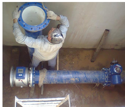
Figura 5.26 – Instalación del caudalímetro y la válvula mariposa motorizada en la Cámara enterrada
