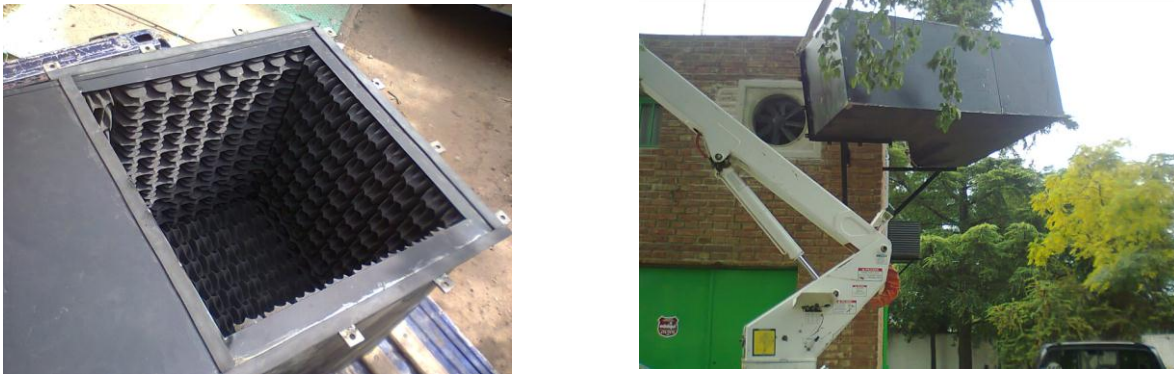
Figura 5.13 – Instalación de conductos de insonorización para la extracción de aire en S.M.
