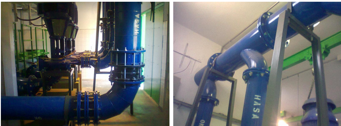
Figura 5.24 –Sistema de Impulsión de la E.E.Guiñazú Baja Presión
