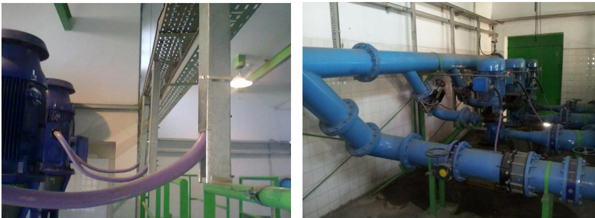
Figura 5.27 – Alimentadores secundarios para bombas de los sistemas de baja presión (izquierda) y alta presión (derecha) y canalización de bandeja perforada diferenciada para potencia y señales
