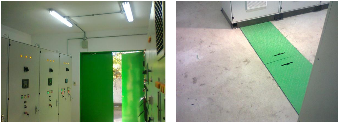
Figura 5.10 –Interior de la Sala de Tableros
