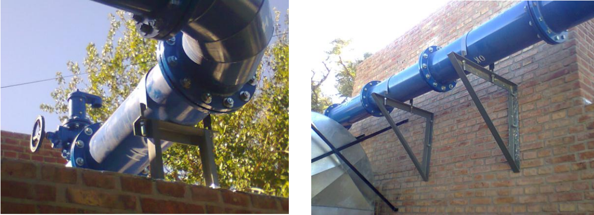
Figura 5.25 – Cañería elevada exterior sobre Sala de Máquinas
