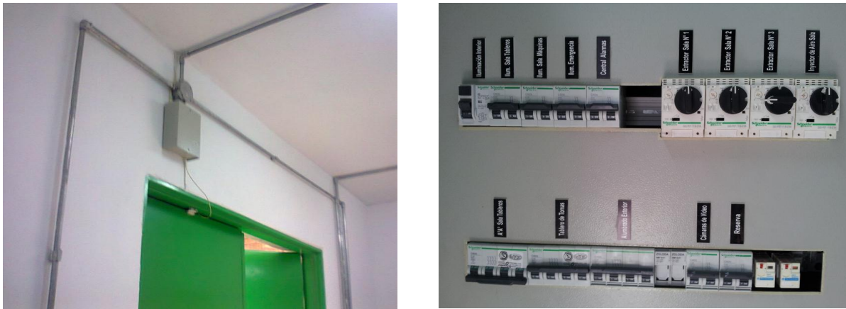
Figura 5.28 – Canalización de servicios y T.S.S. en Sala de Tableros
