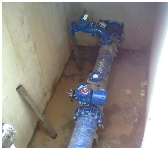
Figura 5.22 – Salida de la Impulsión del sistema de baja presión. La obra de red se empalma luego del caño pasamuro continuando hasta el empalme con la red existente en vereda
