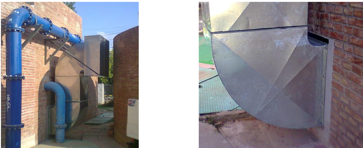
Figura 5.14 – Conducto de insonorización y filtrado para la inyección de aire a la S.M.
