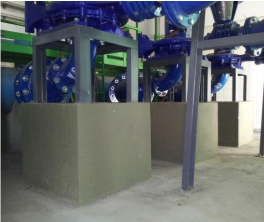
Figura 5.11 – Bases de bombas en Sala de Máquinas
