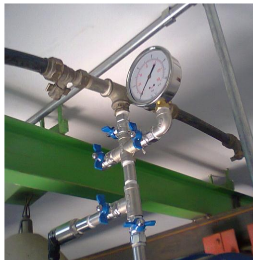
Figura 5.31 – Manifold de medición de presión y toma para el transductor de presión
