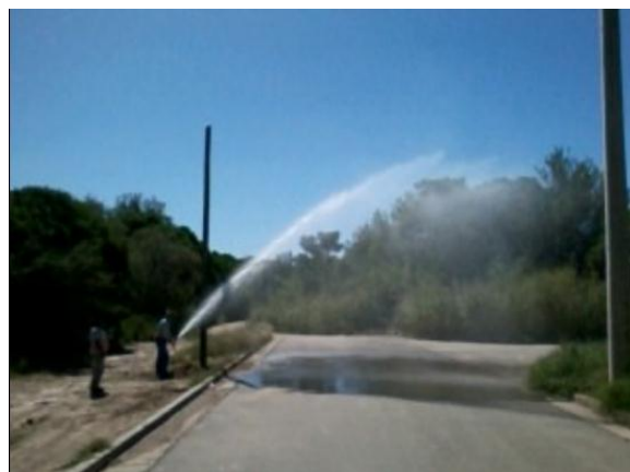
Figura 4.10 – Fotografía de la descarga de presión de cañería de PVC DN110mm - Obra N°57- luego de la prueba hidráulica
