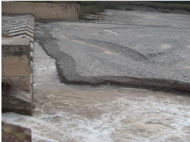
Figura 5: Erosión local al pie de la estructura de descarga
