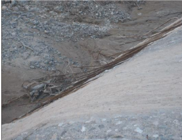
Figura 6: Abrasión en el perfil del vertedero del Dique Fijo (DF)
