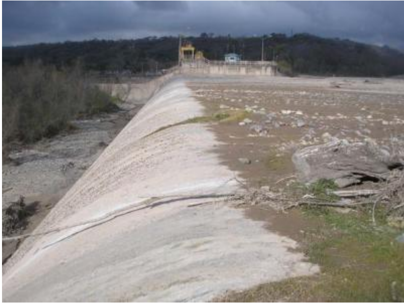
Figura 4: Tarquinamiento del Dique Fijo
