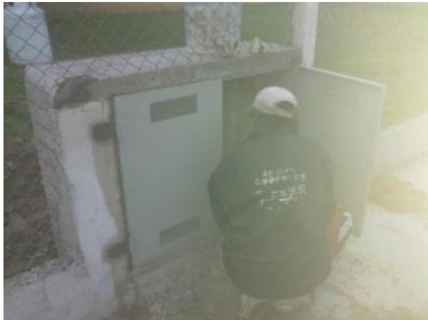
Figura 3.8: Gabinete de regulación y medición.
