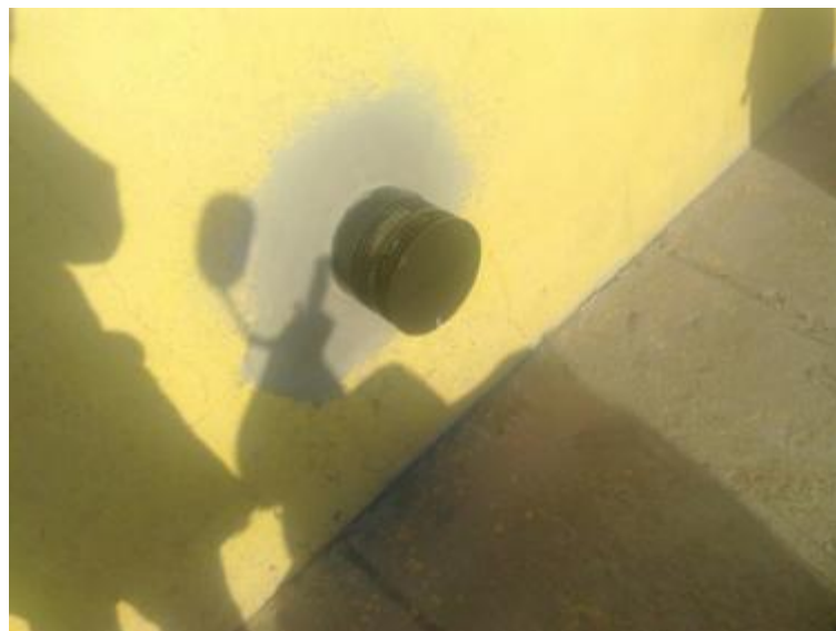
Figura 3.6: Conducto de ventilación
