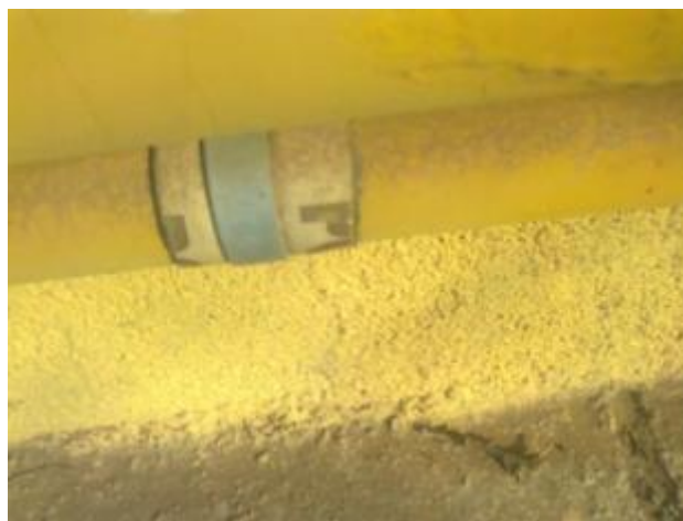
Figura 3.3: Aislante de cañería.
