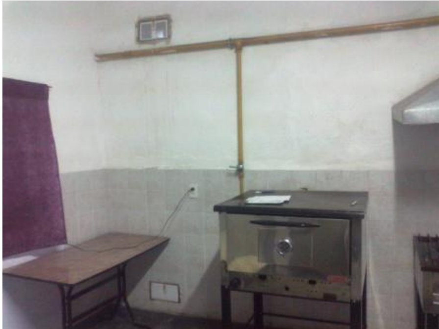
Figura 3.7: Rejillas de ventilaciones superiores e inferiores.
