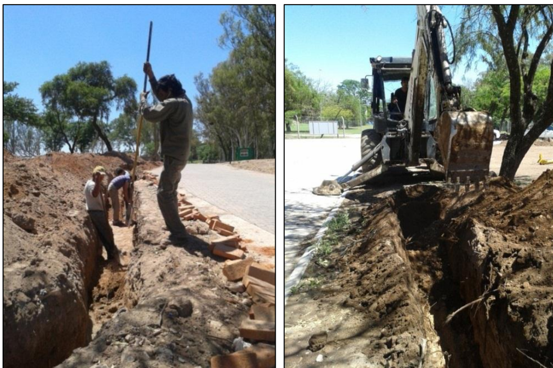
Figuras 14 y 15: Excavación a mano en roca disgregada y a máquina en suelo común – Media tensión
