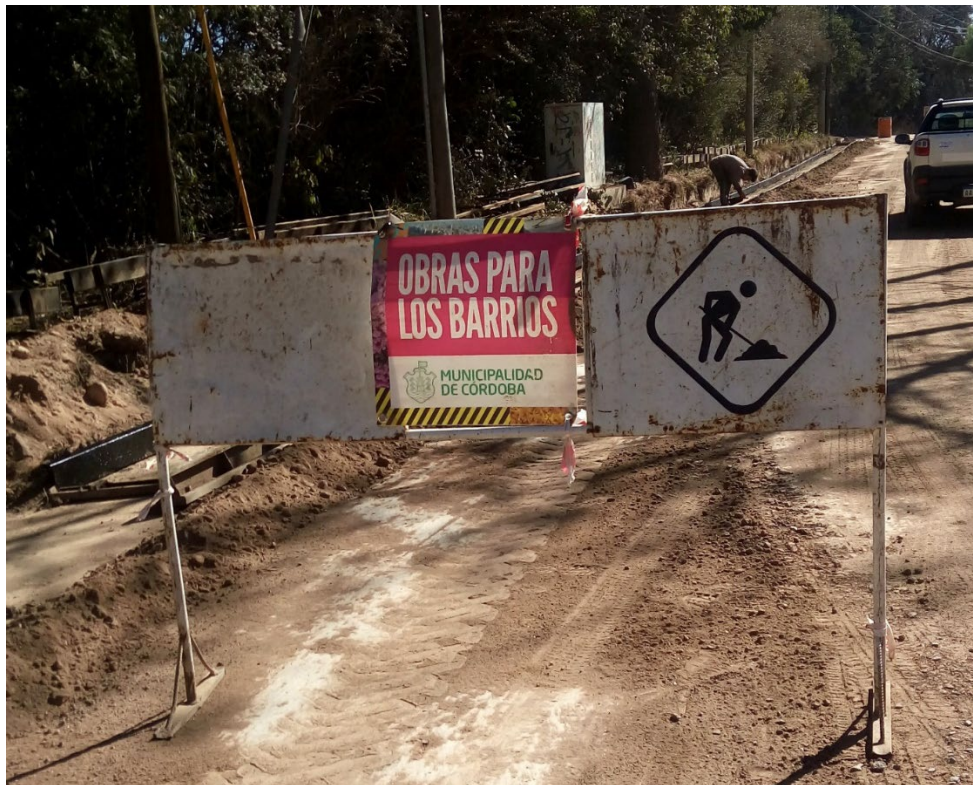
Figura 5.5: Cartelería de Señalización. – Fuente: Elaboración Propia.
