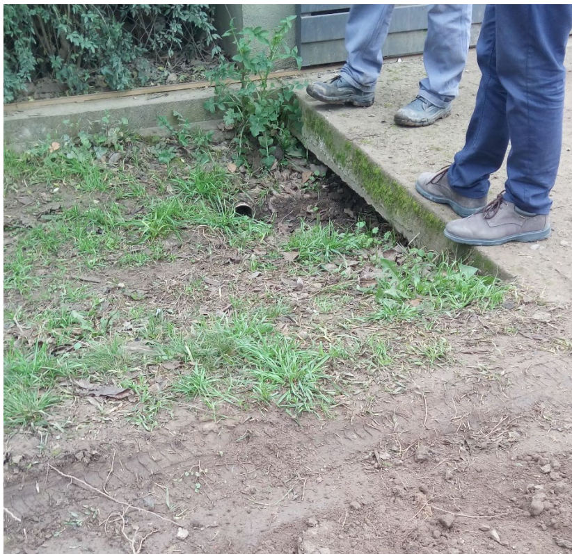
Figura 5.1: Albañal no relevado en el proyecto. – Fuente: Elaboración Propia.
