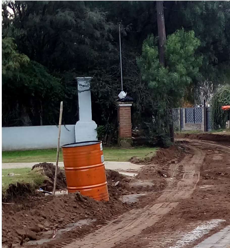
Figura 5.6: Cartelería de Señalización. – Fuente: Elaboración Propia.
