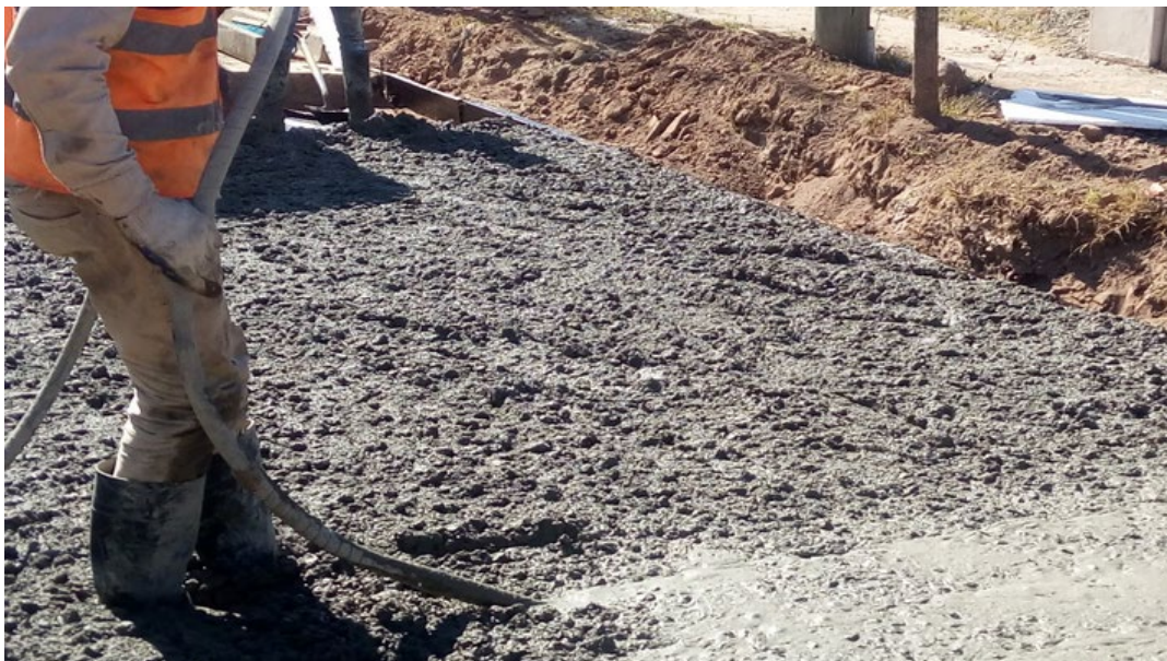
Figura 5.24. Vibrado del hormigón en bocacalle con vibrador monofásico de tipo aguja. – Fuente: Elaboración Propia
