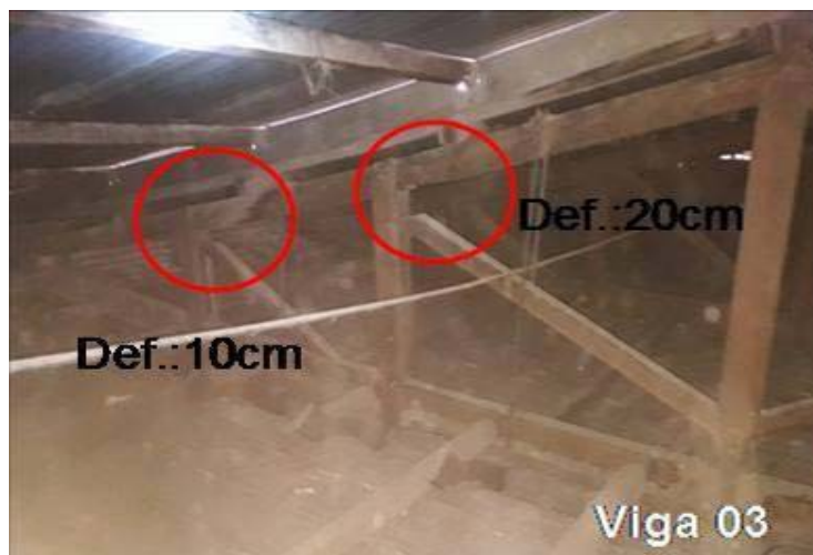
Gráfico N° 19: Imagen de cercha de madera 3 con relevamiento de daños
