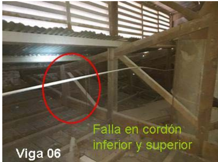
Gráfico N° 20: Imagen de cercha de madera 6 con relevamiento de daños
