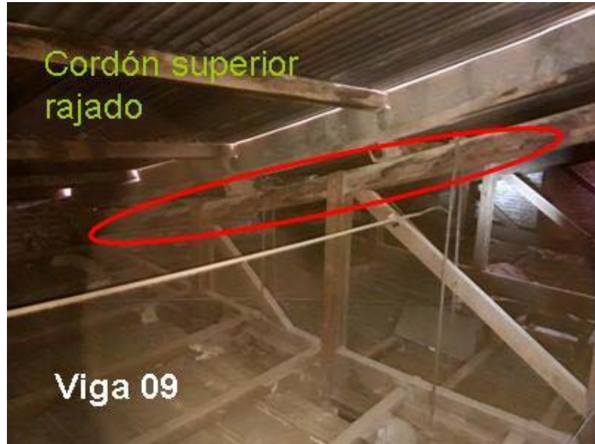
Gráfico N° 21: Imagen de cercha de madera 9 con relevamiento de daños
