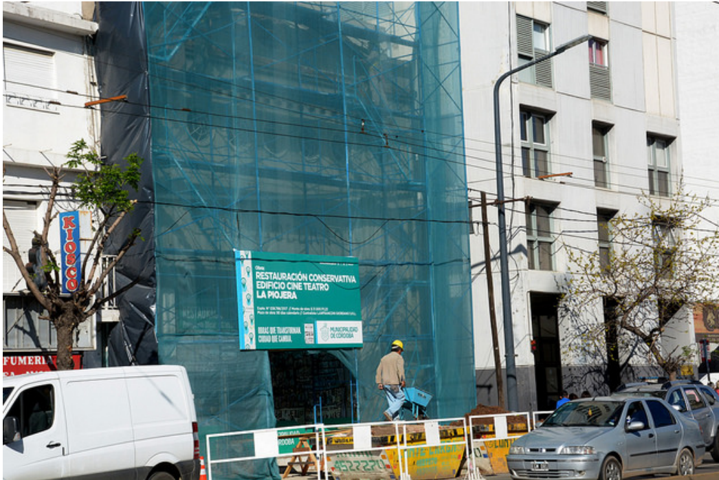
Gráfico N° 28 : Vista del sistema de andamios completo ya durante los trabajos de restauración
