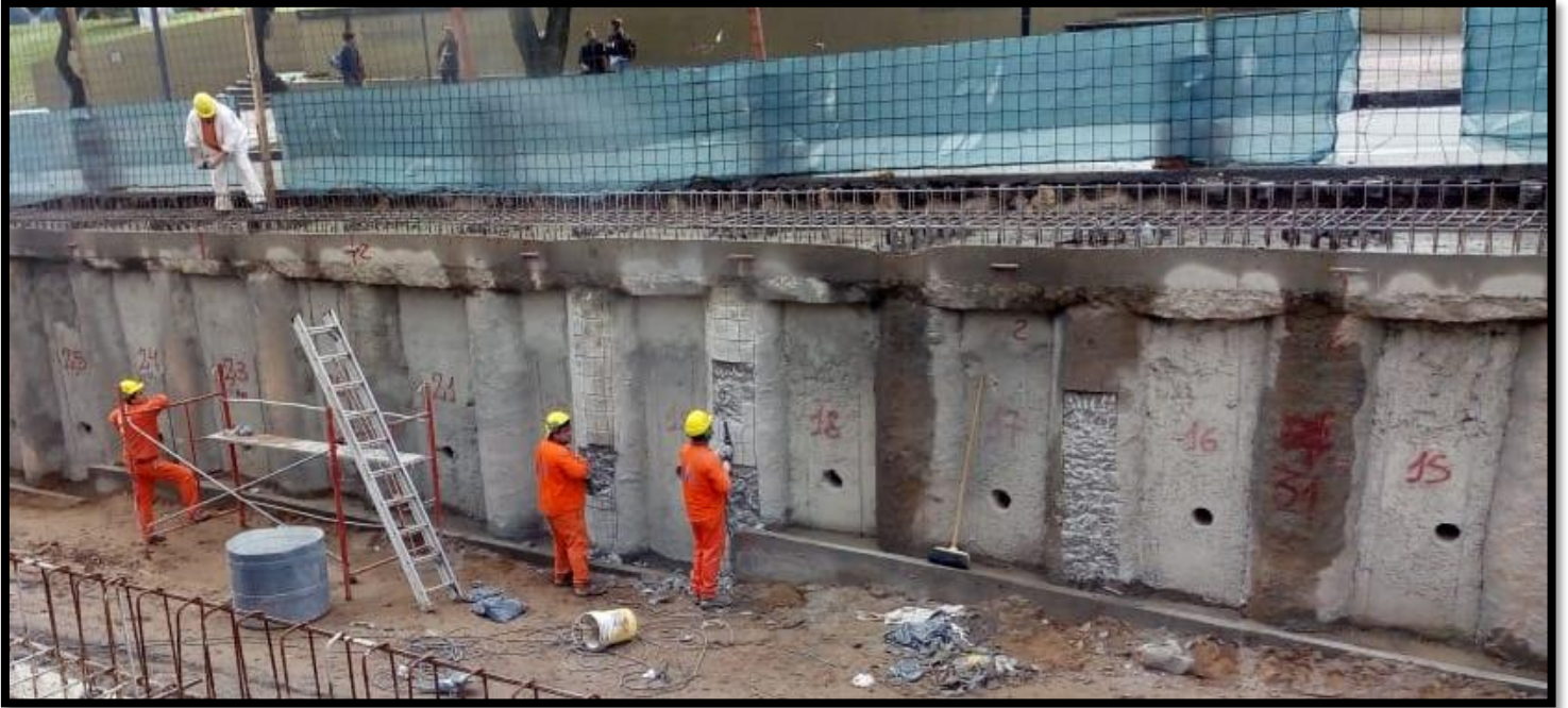
Figura 46: Corrección de pilotes
