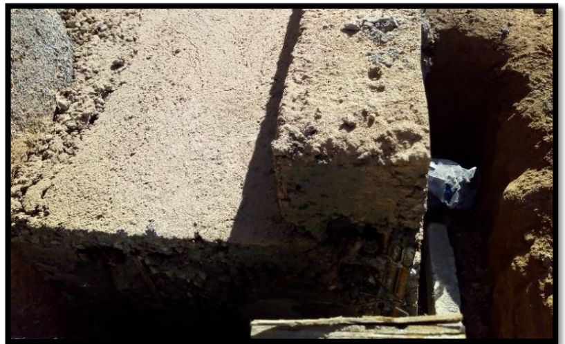
Figura 43: Errores constructivos viga PP
