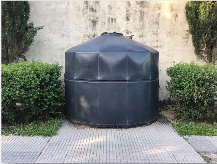
Ilustración 24: Tanque de reserva de agua.
