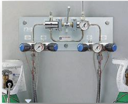
Ilustración 29: Manifold y reguladores. 10
